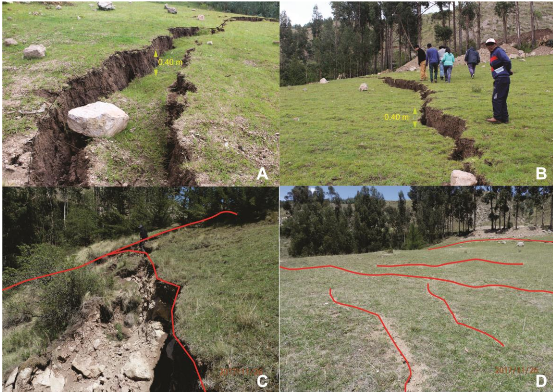
Fotografía 2. la vista A y B) se observa el escarpe principal con salto de 0.40 m aproximadamente; C) se observa a la margen derecha sector donde se genera derrumbe de menor magnitud; D) se observa la zona donde se generaron agrietamientos.
