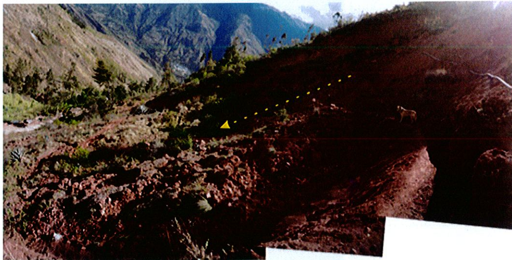
Foto 7. Se muestra en material suelto generado por el deslizamiento.
