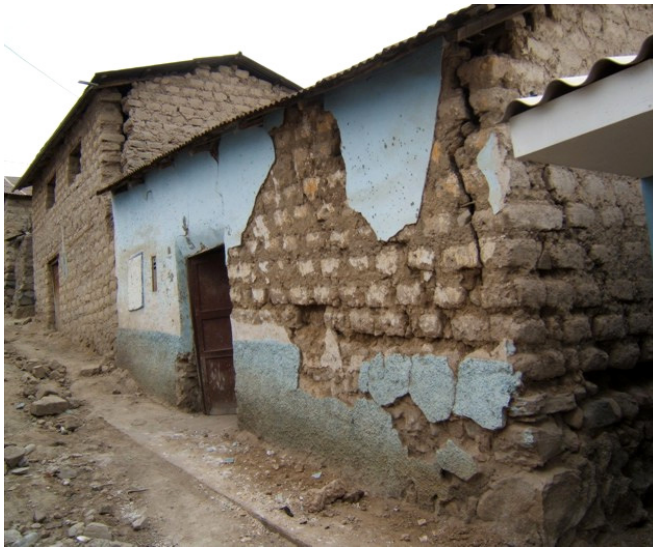
Fig. 4.4: Caída del revestimiento de la fachada de una vivienda en el poblado de Bellavista.
