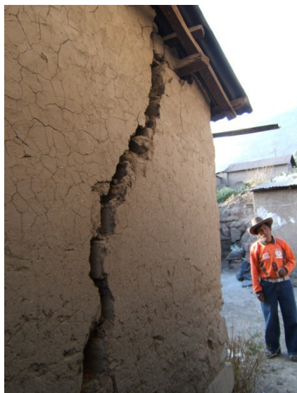
Fig. 4.10 Agrietamiento en las paredes de varios centímetros de ancho.
