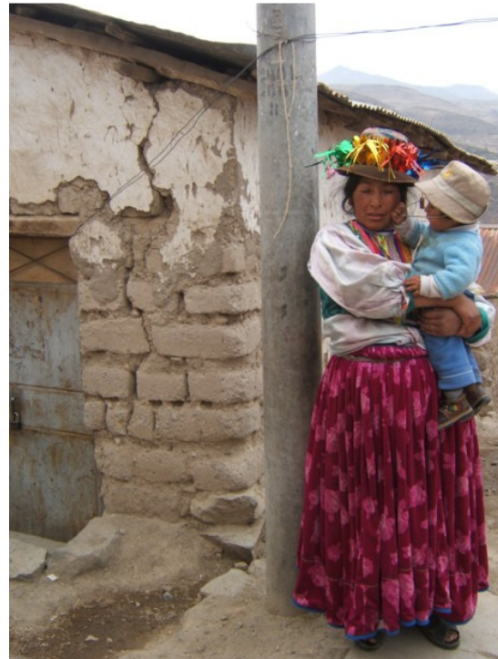
Fig. 4.7: Agrietamiento en la esquina de una vivienda (Poblado de Calacoa)
