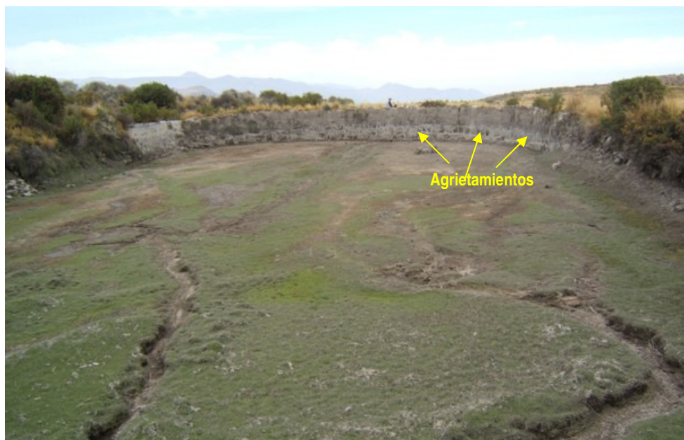
Fig. 3.15: Agrietamientos en las paredes internas del reservorio.
