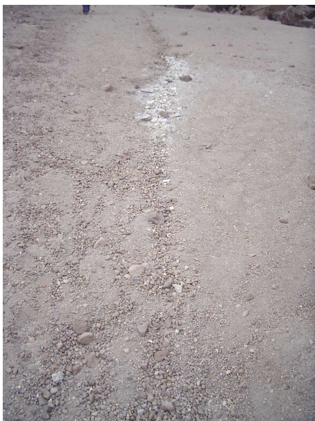
Fig. 5.18. Grietas observadas durante el ascenso al volcán Ticsani
