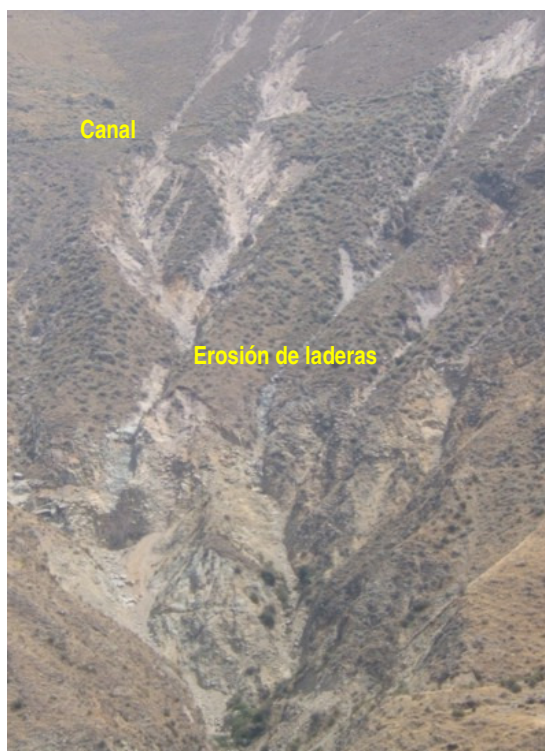
Fig. 3.17: Derrumbe y erosión de laderas.
