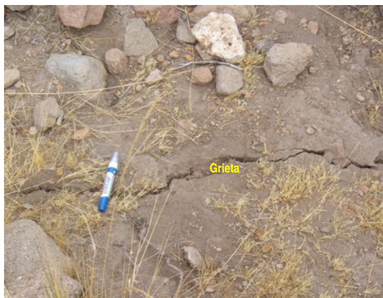
Fig. 3.10: Grieta de 2 a 3 cm de ancho, ubicado en la cabecera del deslizamiento en el sector de Trapiche
