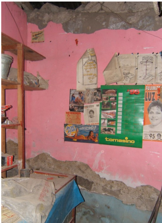
Fig. 4.6: Caída del revestimiento de un muro interno de una vivienda del poblado de Calacoa
