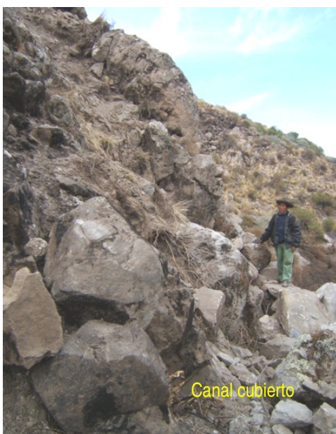
Fig. 3.11: Derrumbes de bloques de lava que cubren el canal.
