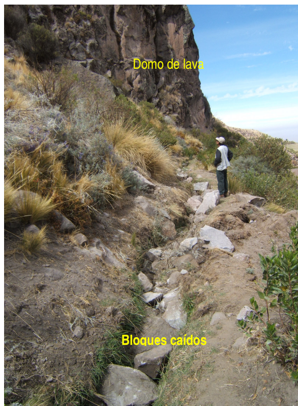
Fig. 3.6: Derrumbes de bloques de lava que afectan canal de agua de regadío de Calacoa.
