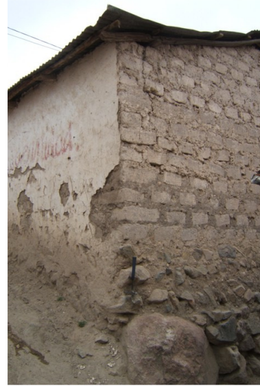
Fig. 4.5: Agrietamiento en la esquina. La base es de piedra y barro.
