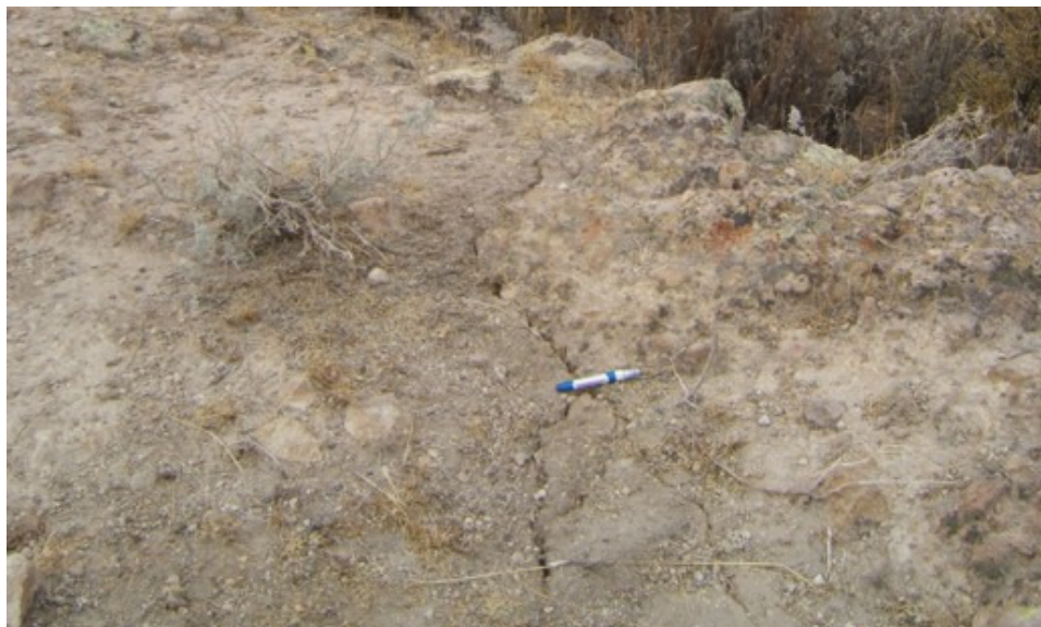
Fig. 3.19: Agrietamientos de 2 cm de ancho y más de 8 m de largo, localizados en la parte alta de la corona del deslizamiento.
