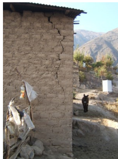
Fig. 4.9: Agrietamiento de paredes en una vivienda recientemente construida
