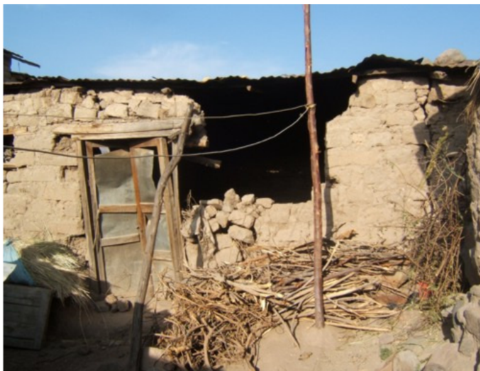
Fig. 4.8: Derrumbe de pared de una vivienda antigua.
