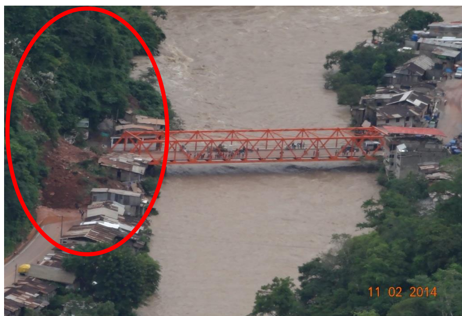
Fotos 10. Foto del deslizamiento ocurrido el año 2014 en el estribo sur del Puente Paucartambo. Foto INDECI - Villa Rica.
