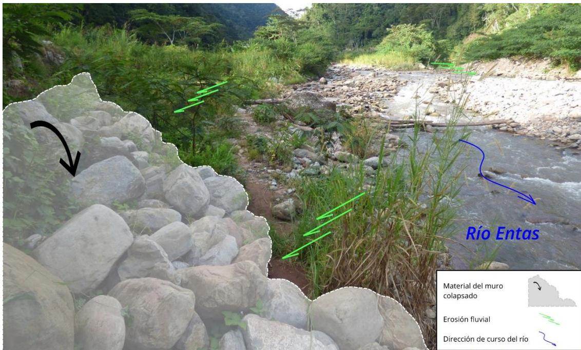
Figura 8. Zona de erosión fluvial en la margen derecha del río Entas – Sector San Antonio.
