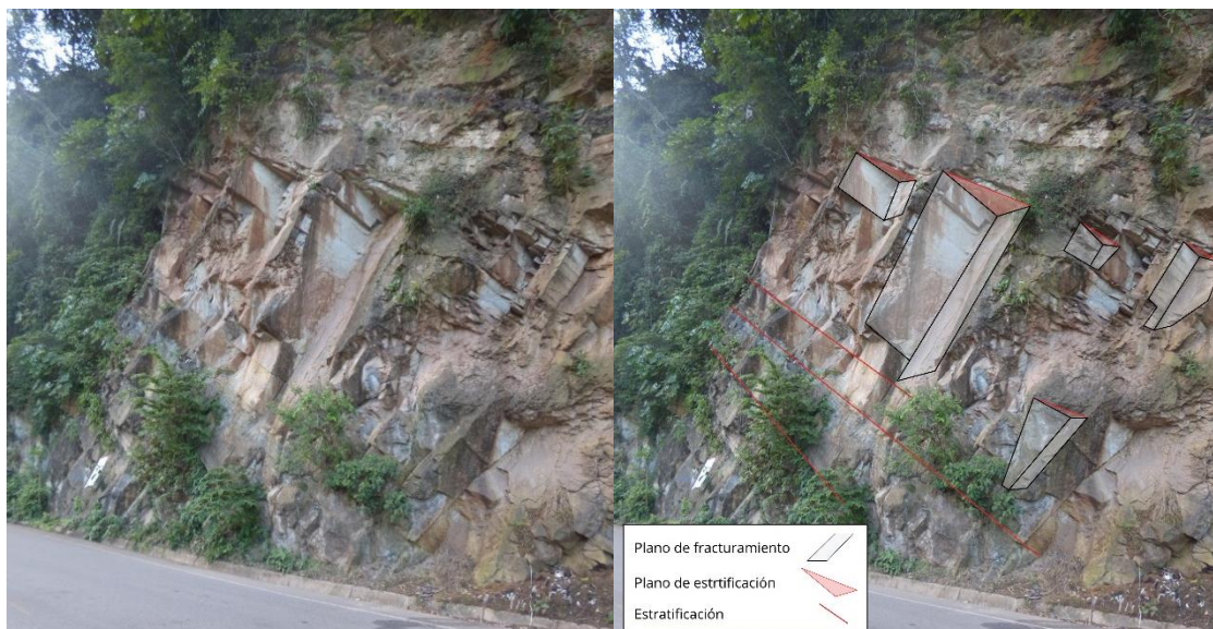
Figura 12. Talud con fracturamiento en forma de cuña en tramo carretero de Puente Paucartambo.
