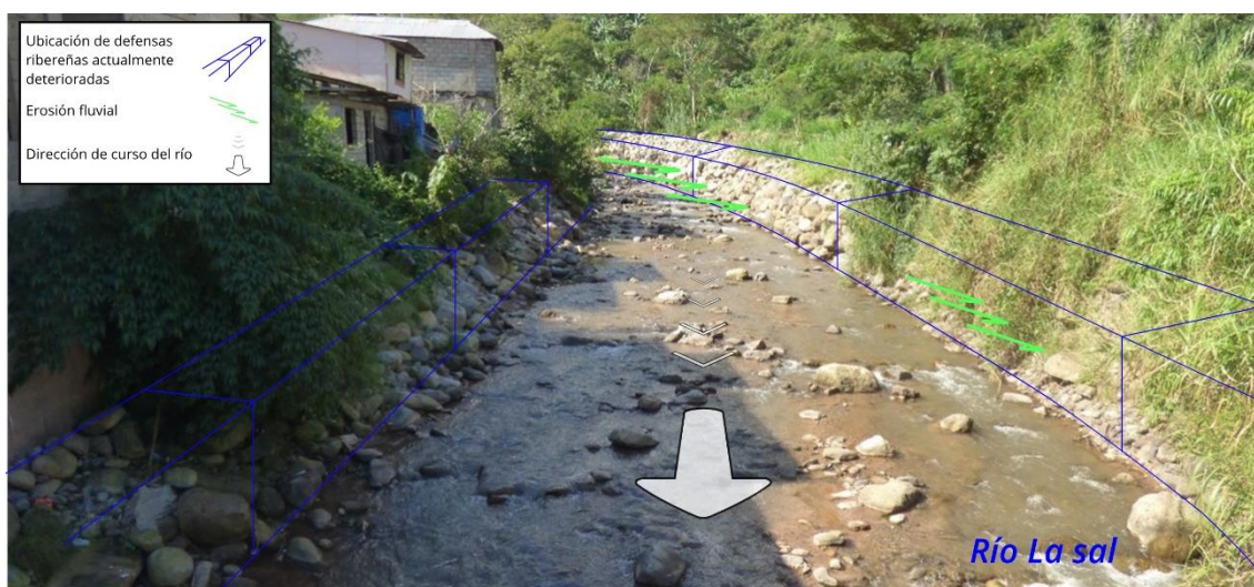
Figura 7. Río La Sal con defensas ribereñas tipo enrocado deterioradas por erosión fluvial.
