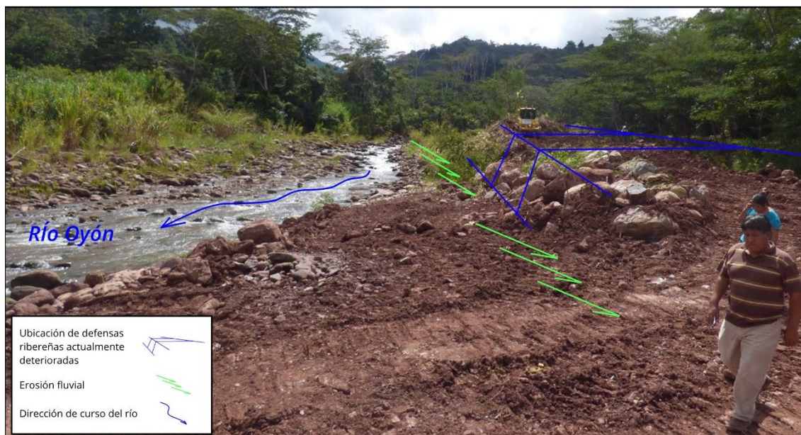
Figura 8. Río La Sal con defensas ribereñas tipo enrocado deterioradas por erosión fluvial.
