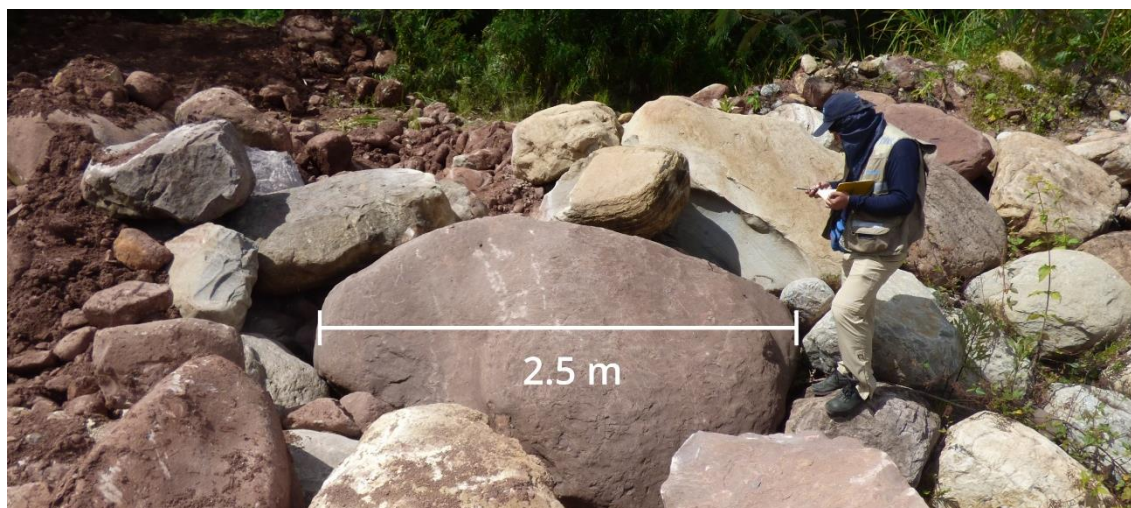
Foto 7. Río La Sal con defensas ribereñas tipo enrocado deterioradas por erosión fluvial.
