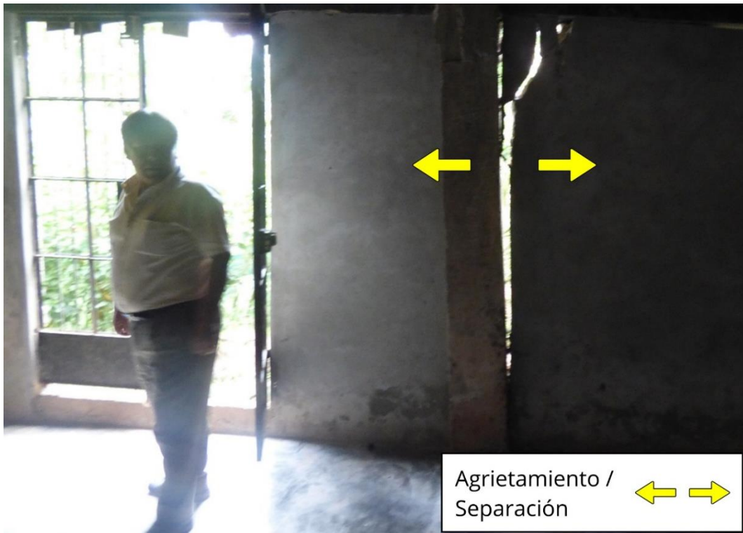
Figura 16. Infraestructura afectada por deslizamiento en Villa Oyón.
