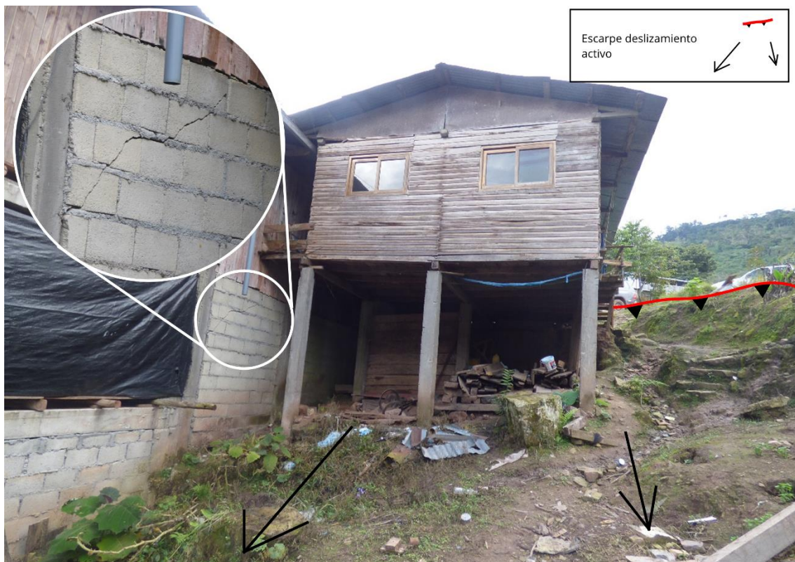
Figura 17. Agrietamientos afectando infraestructura ubicada en el cuerpo del deslizamiento latente.
