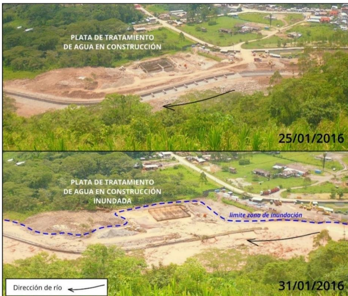
Figura 12. Crecida, desborde e inundación del año 2016, afectando la construcción de la actual planta de tratamiento de agua. Fotos INDECI - Villa Rica.
