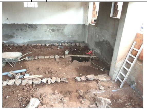
Figura N° 5.8.- Manante que genera humedecimiento en la estructura de una vivienda, APV. Los Jardines.
