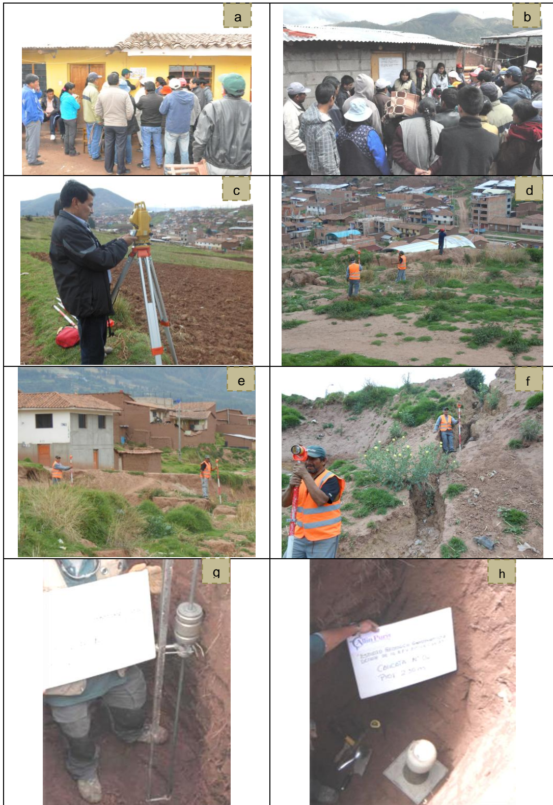
Figura N° 2.1.- a y b.- Taller desarrollado el 5 de enero del 2014 con los pobladores de la Asociación de Vivienda Altiva Canas. c, d, e y f.- Levantamiento topográfico en el área de estudio. g y h.- Estudio geotécnico - penetrometro y cono de arena.
