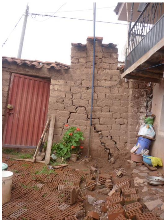
Figura N° 4.6.- Agrietamientos en las viviendas en la Asociación de Vivienda Altiva Canas, Mz. S - 9 Fuente: Francisco Escobar Choque, damnificado de la Asociación de Vivienda Altiva Canas
