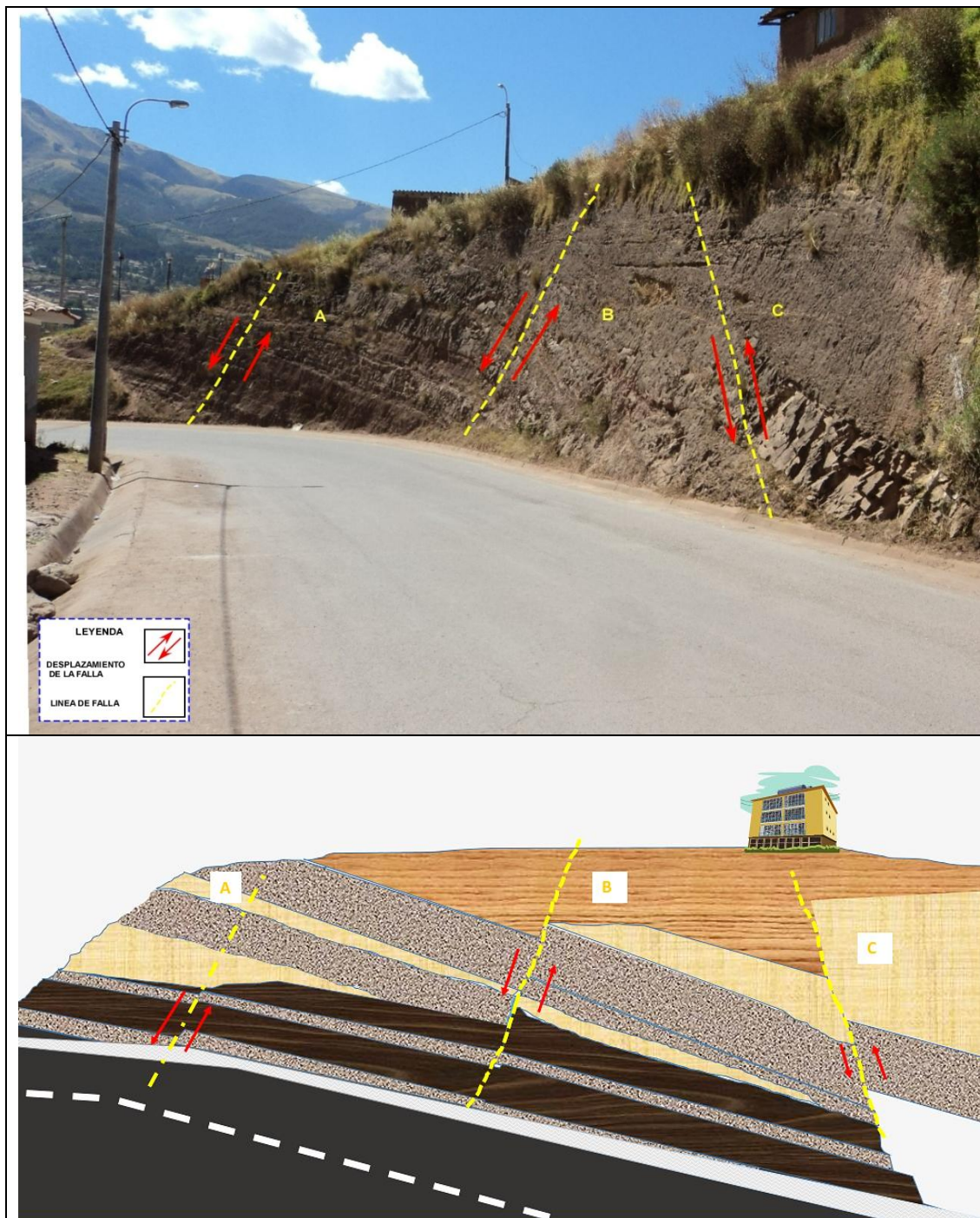
Figura N° 4.37.-Fallas A, B y C ubicadas en la Avenida Red Energia del Peru Fuente : Equipo consultor Allin Puriy, 2014.
