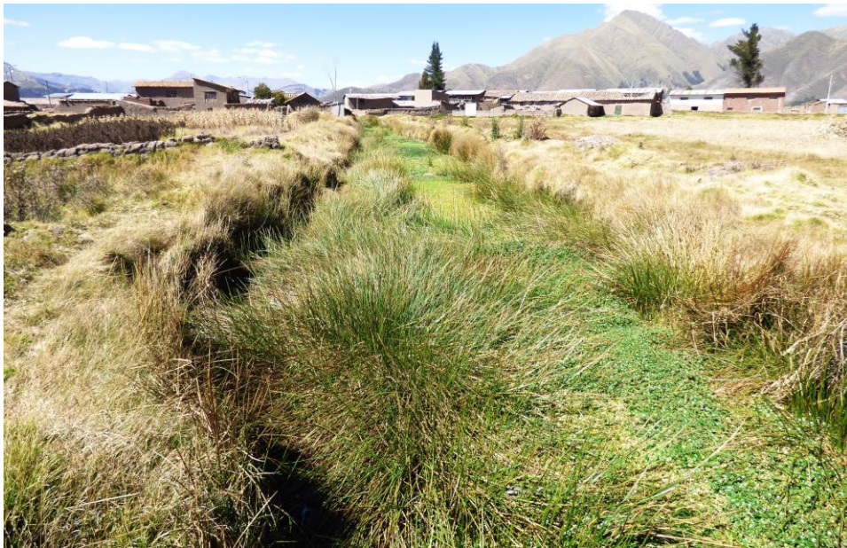
Fotografía 10. Canal de captación de aguas pluviales que cruza el Barrio Vilcanota
