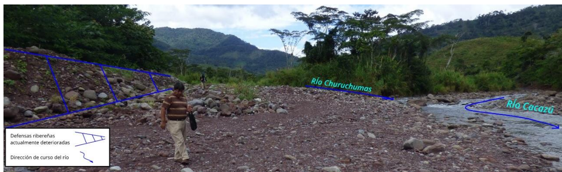
Figura 14. Defensas ribereñas tipo enrocado deterioradas por erosión fluvial, en la margen derecha del río Churuchumas, afluencia al río Cacazú.
