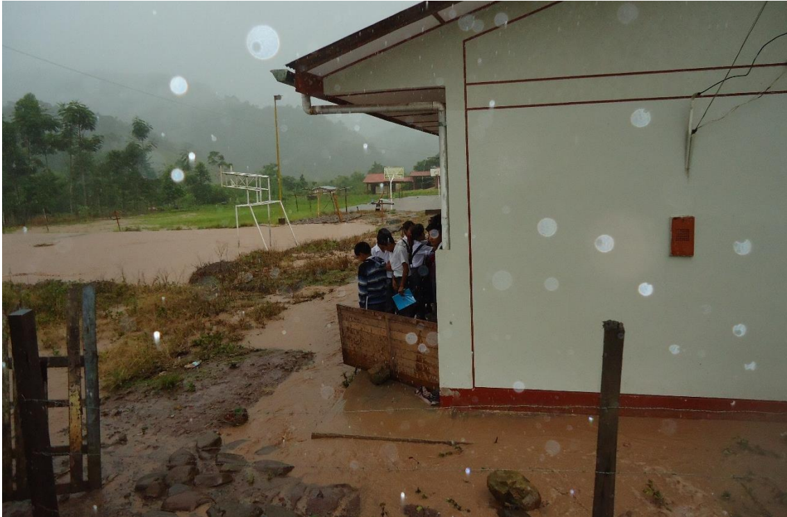
Foto 2. Colegio afectado por inundaciones. Foto INDECI - Villa Rica.
