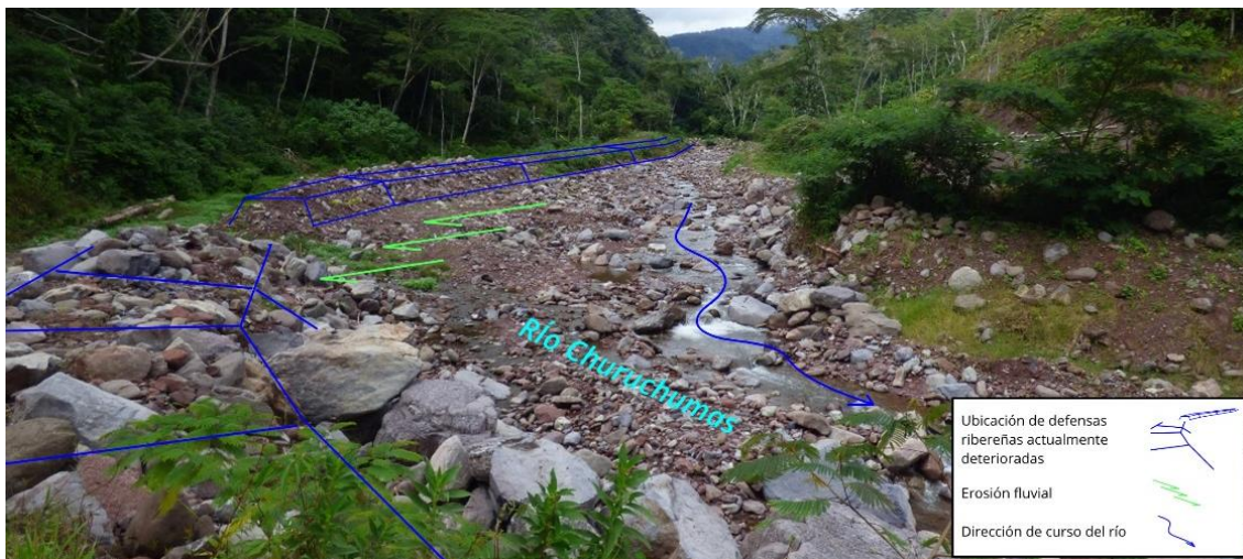
Figura 8. Defensas ribereñas tipo enrocado deterioradas por erosión fluvial, en la margen derecha del río Churuchumas.
