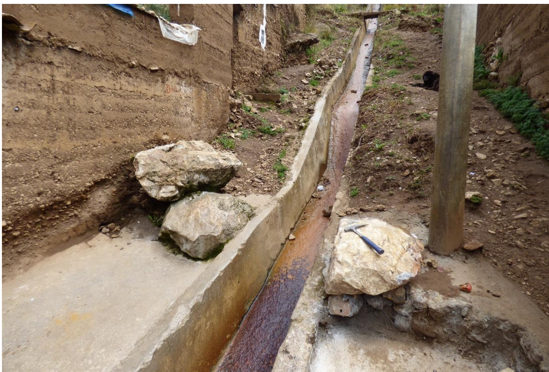
Foto 1. Rocas caídas en el evento de marzo del 2018, en calle del Barrio la Quinta Boliviana.
