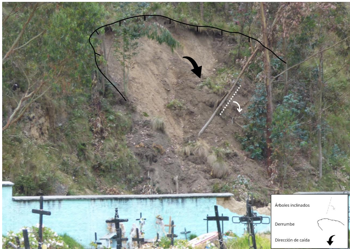
Figura 12. Derrumbe en la ladera adyacente al cementerio de Quiparacra.
