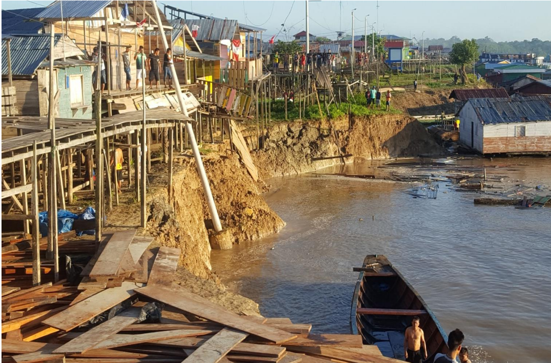
Fotografía 7. Vista tomada de la erosión fluvial el 02 de julio del 2018 en la calle Nuevo Horizonte; afectó viviendas y los postes del sistema eléctrico en la localidad de Islandia. Foto: Municipalidad distrital de Yavarí.
