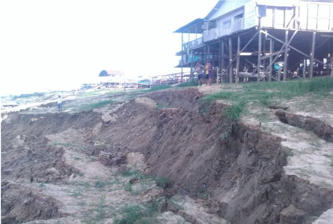
Fotografía 1. Se observa el depósito aluvial donde se encuentra asentada la localidad de Islandia. Foto: Municipalidad distrital de Yavarí.
