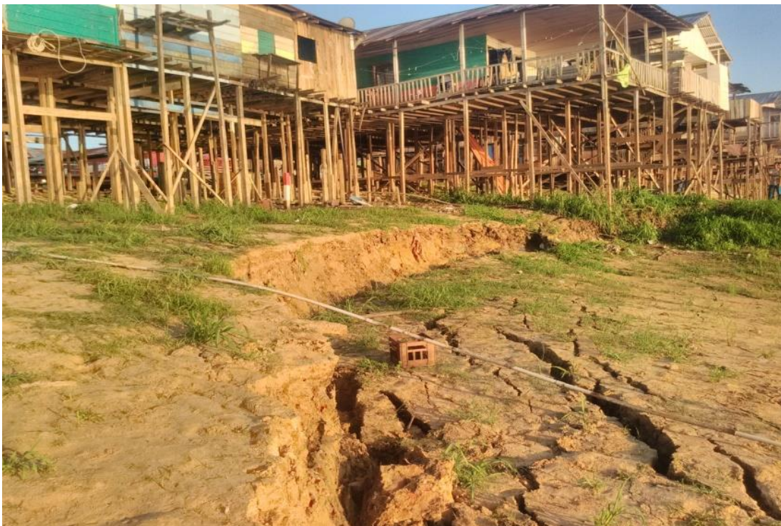
Fotografía 8. Vista tomada el 12 de agosto del 2018 de la escapa de deslizamiento retrogresivo producto de los procesos de la erosión fluvial en la calle 02 de Julio. Localidad de Islandia. Foto: Municipalidad distrital de Yavarí.
