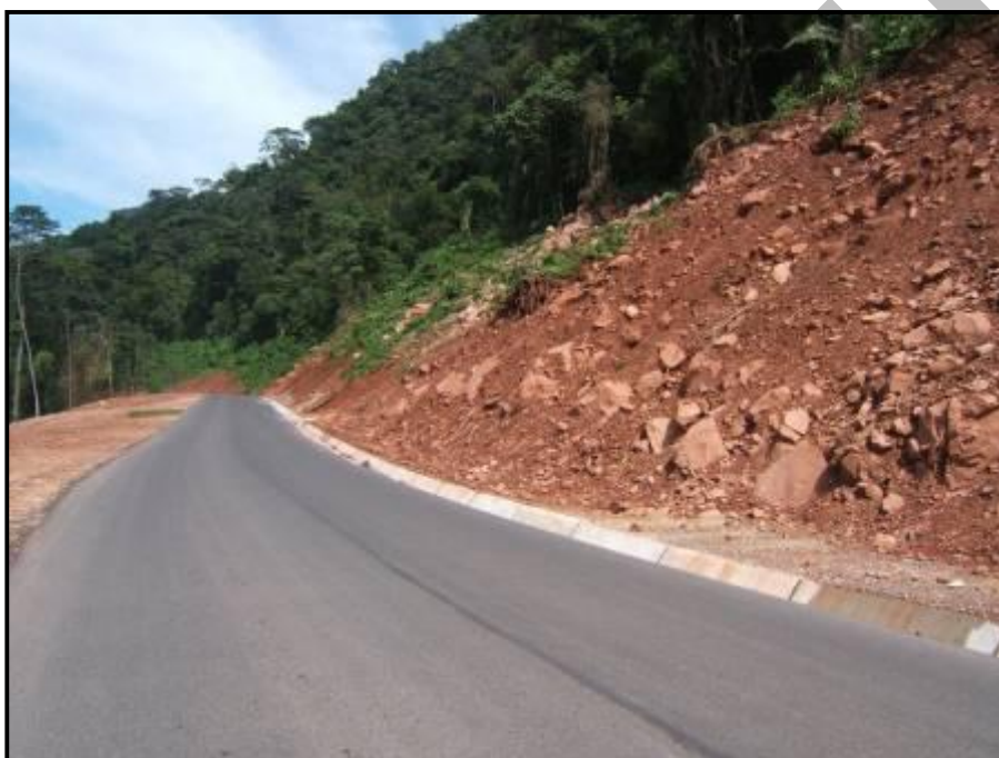
Foto 10.- Carretera Tarapoto – Yurimaguas, Km. 46+880, donde se presentan derrumbes.
