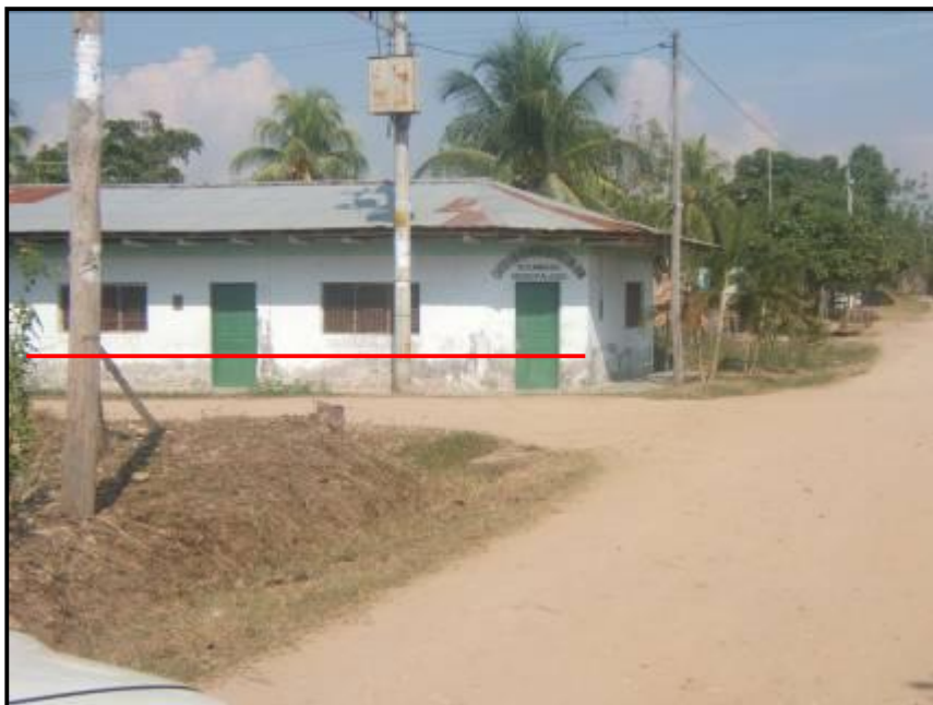
Foto 17.- Sector de Santa Rosa de Cumbaza, se muestra una pared de una vivienda donde se observa la marca del nivel de las aguas que llegaron las últimas inundaciones (2007).
