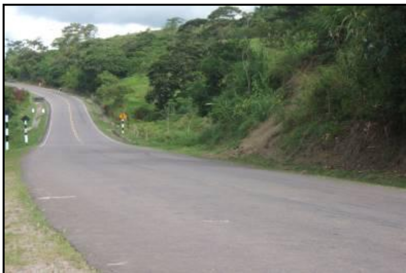
Foto 1.- Sector Gerilla, deslizamiento que afectó a la carretera Tarapoto-Moyobamba en un tramo de 200 m, actualmente esta en proceso de reactivación.
