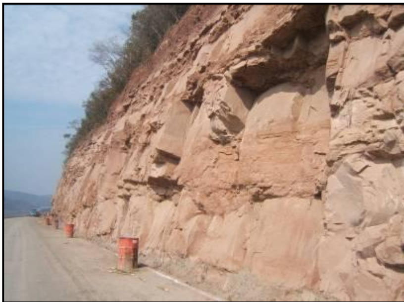
Foto 27.- Carretera Tarapoto Picota, km. 30+320, frente a Pilluana, se pueden presentar caídas de rocas
