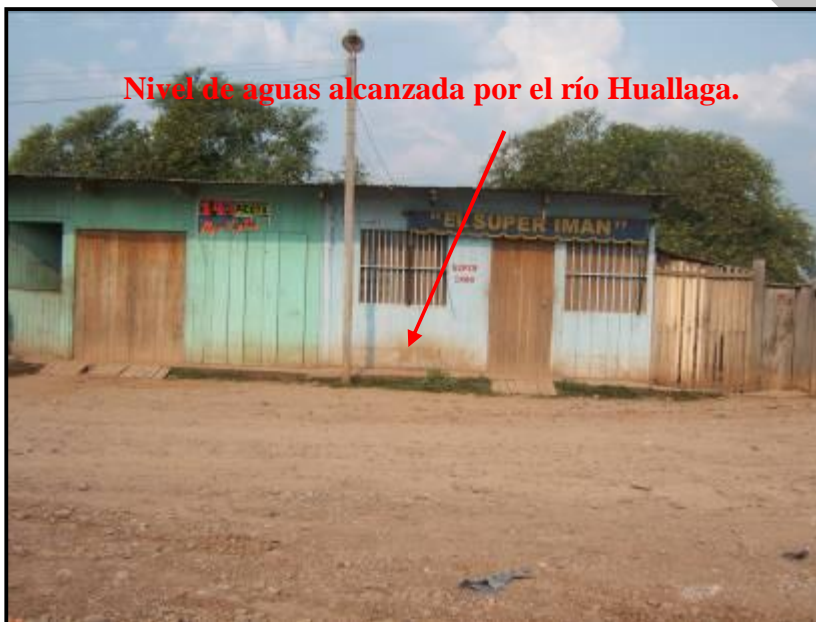
Foto 28.- Sector de Consuelo Villavicencio, en la pared de la vivienda se muestra la huella hasta donde llegó el nivel de agua por desborde del río Huallaga.
