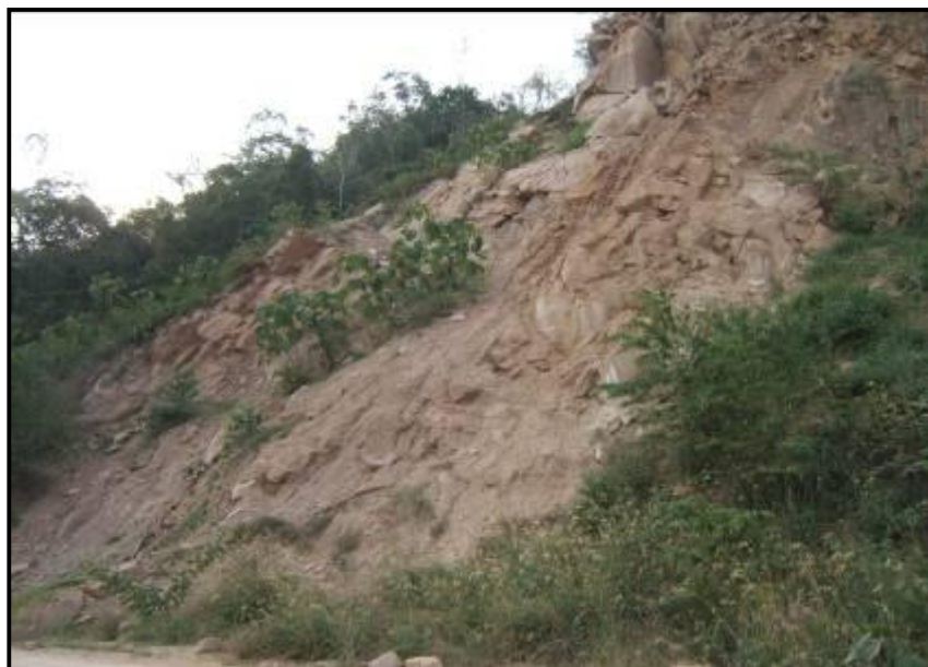
Foto 25.- Sector El Cruce carretera Bellavista-Juanjui, derrumbes generados por corte de talud.
