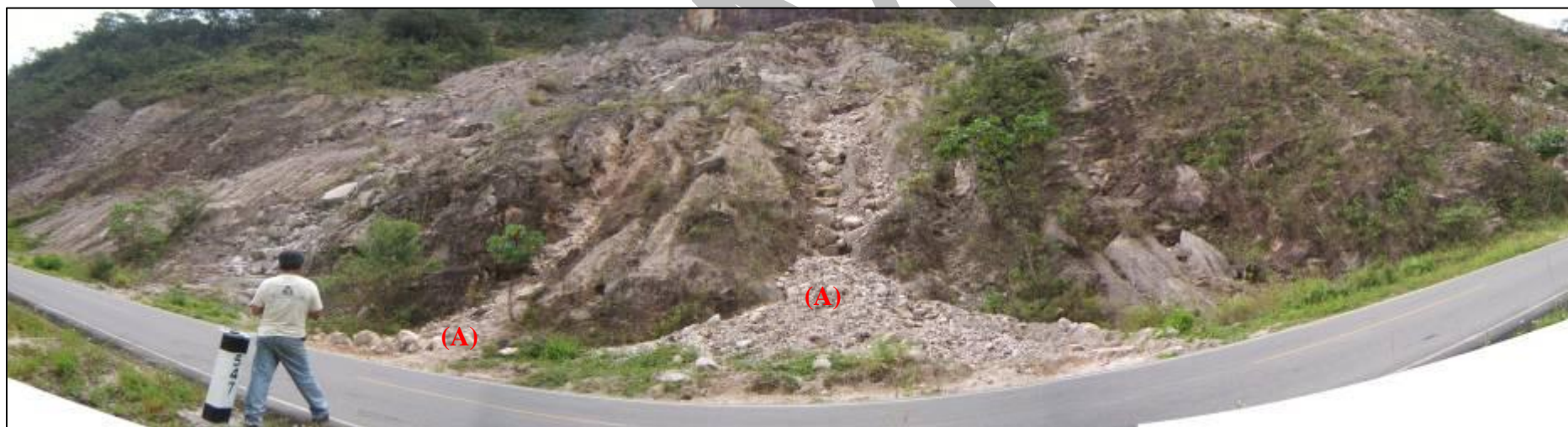
Foto 8.- Deslizamiento traslacional, que afecta a la carretera Tarapoto-Moyobamba a la altura del Km. 574, en el cuerpo del deslizamiento se observa material suelto y conos de talus (A).
