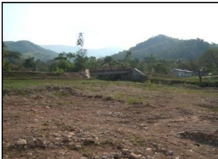
Foto 32.- Sector de Huingoyacu, en la vista se aprecia parte del puente destruido por efectos del flujo que ocurrió en enero del año 2007.
