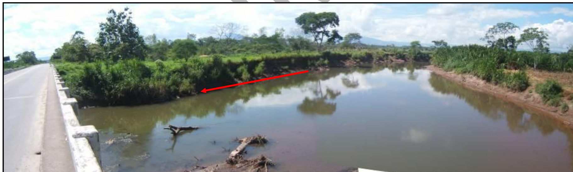
Foto 5.- Puente Tonchima, se aprecia erosiones fluviales sobre la margen derecha. (Foto tomada en junio del 2007).
