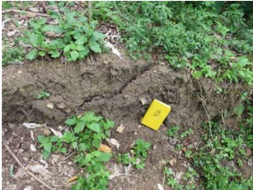
Foto 10: Asentamientos del terreno localizados en la parte alta del caserío La Esperanza
