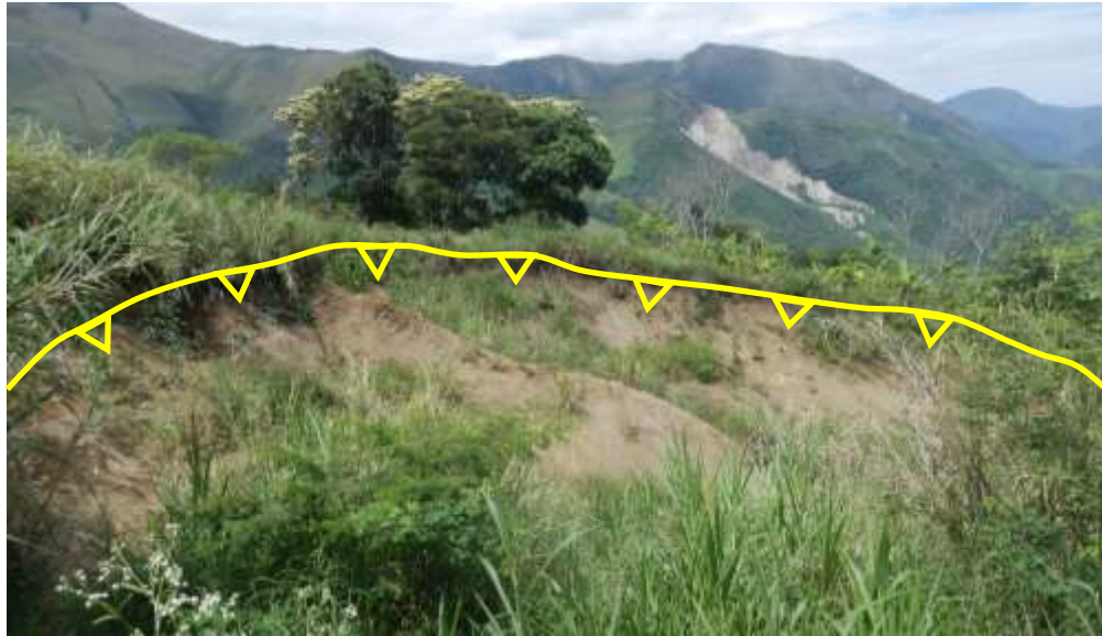
Foto 05: Escarpe de deslizamiento con longitud de 37 m y altura vertical de 7 m.
