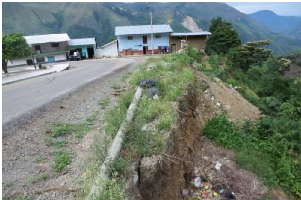
Foto 09: Carretera de acceso al caserío La Esperanza que se encuentra a 3 m del escarpe del deslizamiento.
