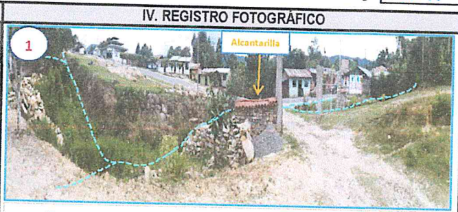
Fotos 01.- Desembocadura de quebradas, caños y cunetas en alcantarilla.
