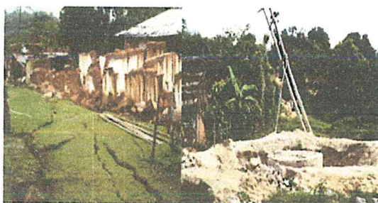
Licuefacción de suelo sector Asungue Barrio de
