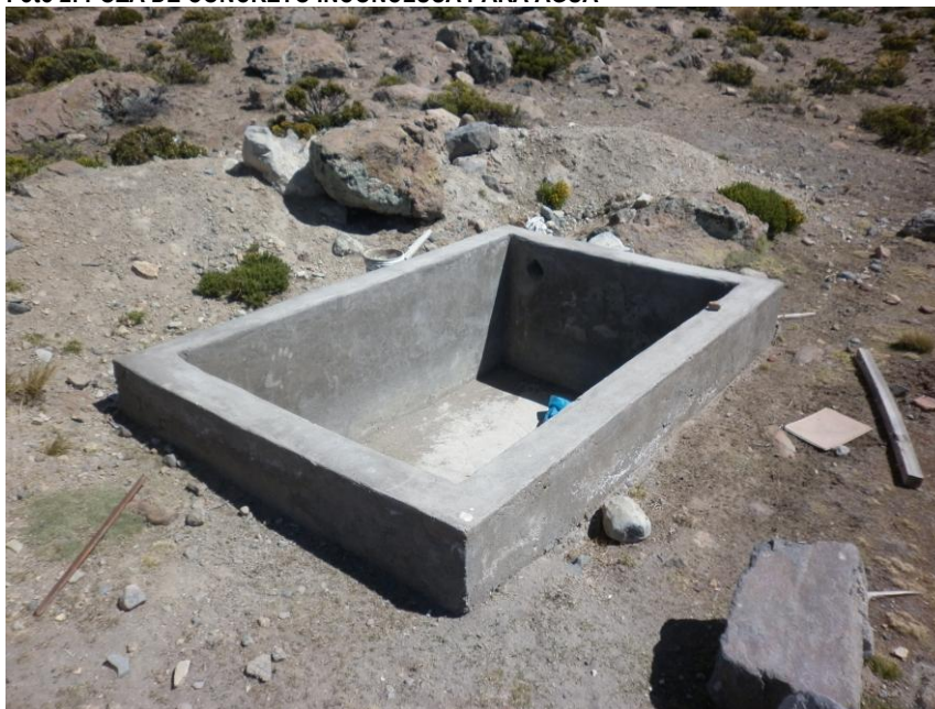
Foto 2: POZA DE CONCRETO INCONCLUSA PARA AGUA
