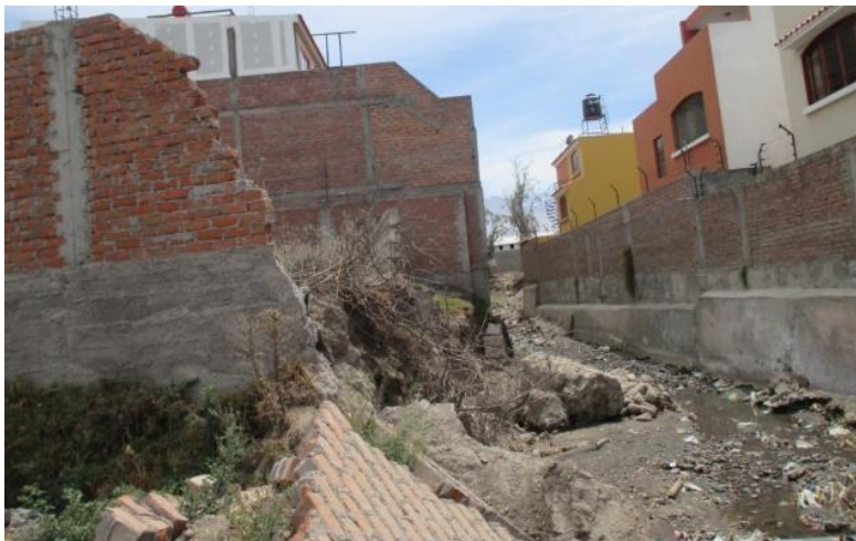
Foto 15: CERCO COLAPSADO EN VIVIENDA URB. BUENA VISTA - 2016
