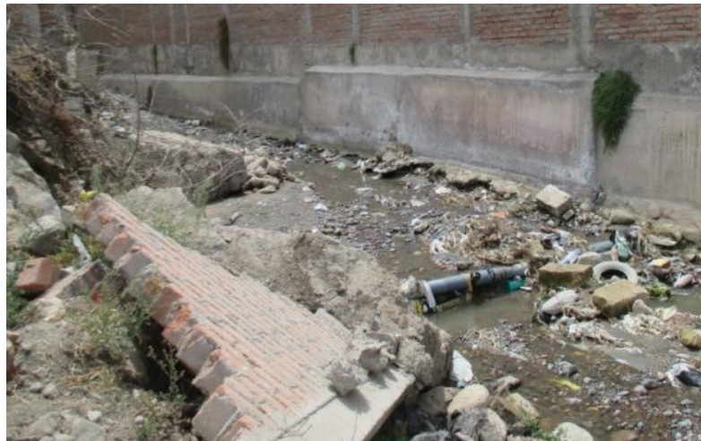
Foto 16: RED DE DESAGUE EXPUESTA URB. SAN RAFAEL
