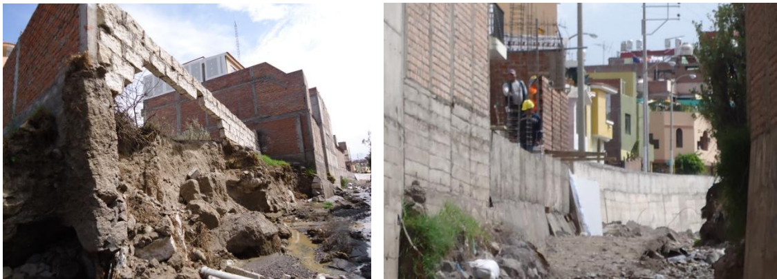
Foto 9: REGISTRO DE CAIDA DE CERCOS PERIMETRICOS BUENA VISTA
