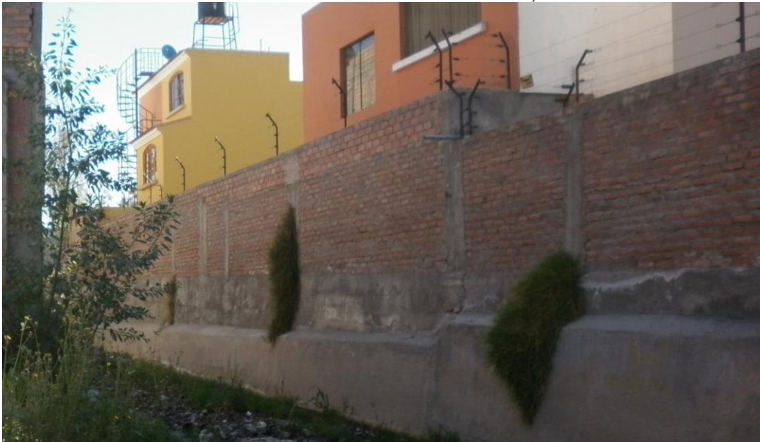
Foto 26: SISTEMA CONSTRUCTIVO CIMENTOS DE CONCRETO SIMPLE, URB. SAN RAFAEL
