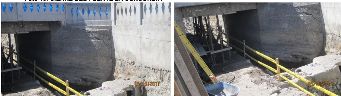
Foto 10: CIERRE DEL PUENTE LA CONCORDIA
