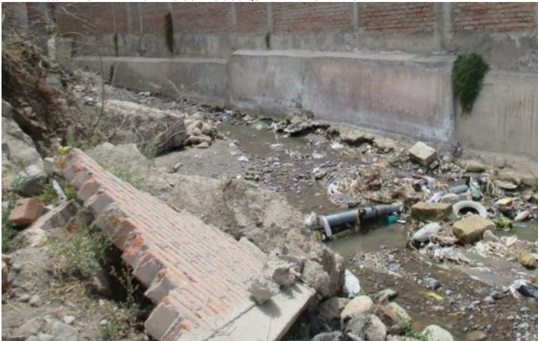
Foto 27: TUBERIA DE SERVICIOS BASICOS QUE ATRAVIESA LA TORRENTERA
