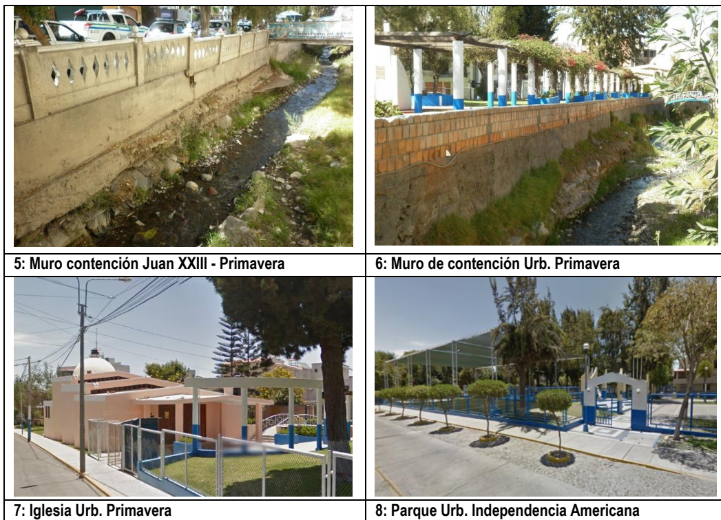
Fuente: Inspección de campo 2018 – MDY
