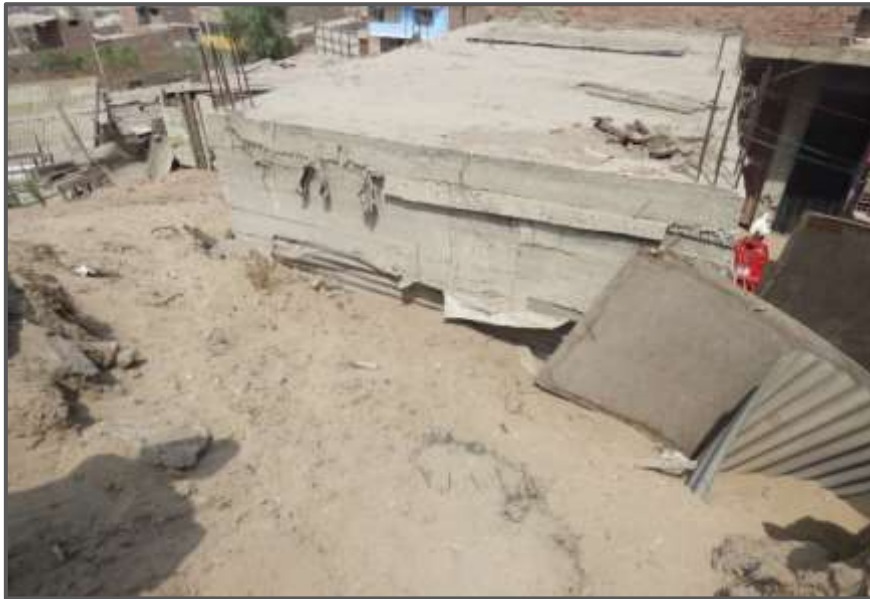
Foto 8: Las viviendas de material noble construidas sobre las arenas podrían colapsar por sobrecarga.
