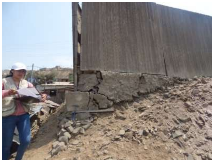
Foto 15: Se observa viviendas ubicadas sobre cimentaciones artesanales (pircas).
