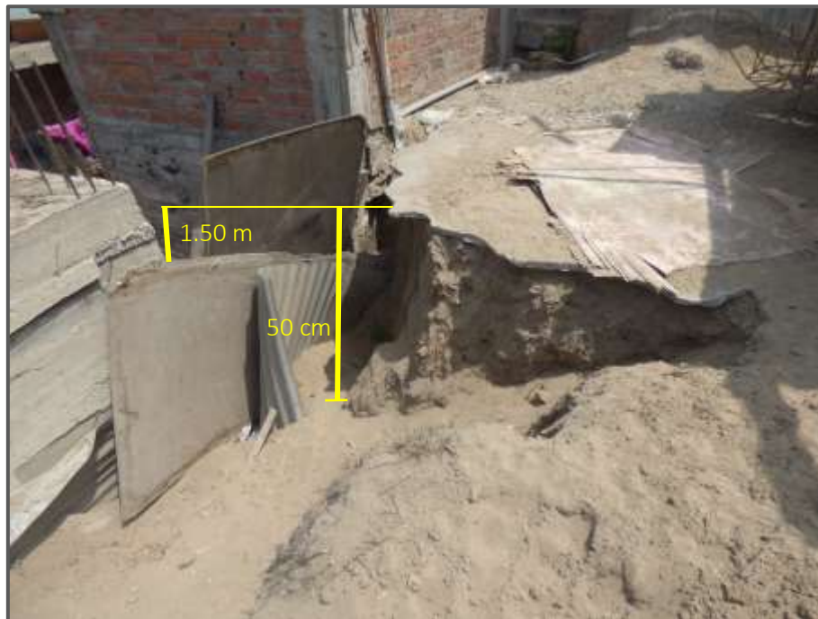
Foto 9: Se observa cortes de talud de más de 1 m de altura para la construcción de viviendas. Además se observa que el talud es inestable, el depósito está buscando su nivel de equilibrio.
