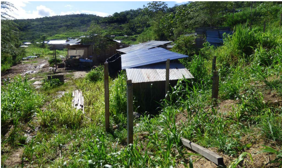
Foto 9. Sector afectado por los asentamientos diferenciales.
