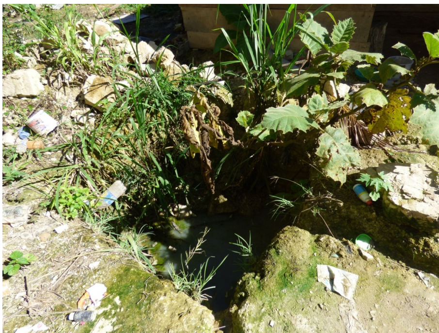
Foto 12. Colector pluvial, mal diseñado que permite la infiltración de agua al subsuelo.
