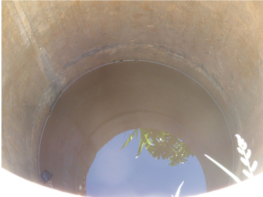
Foto 6. Buzón de desagüe inoperativo.
