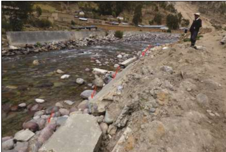
Foto 8. Sector Hatumpampa. Procesos de erosión fluvial, indicados con flechas rojas.
