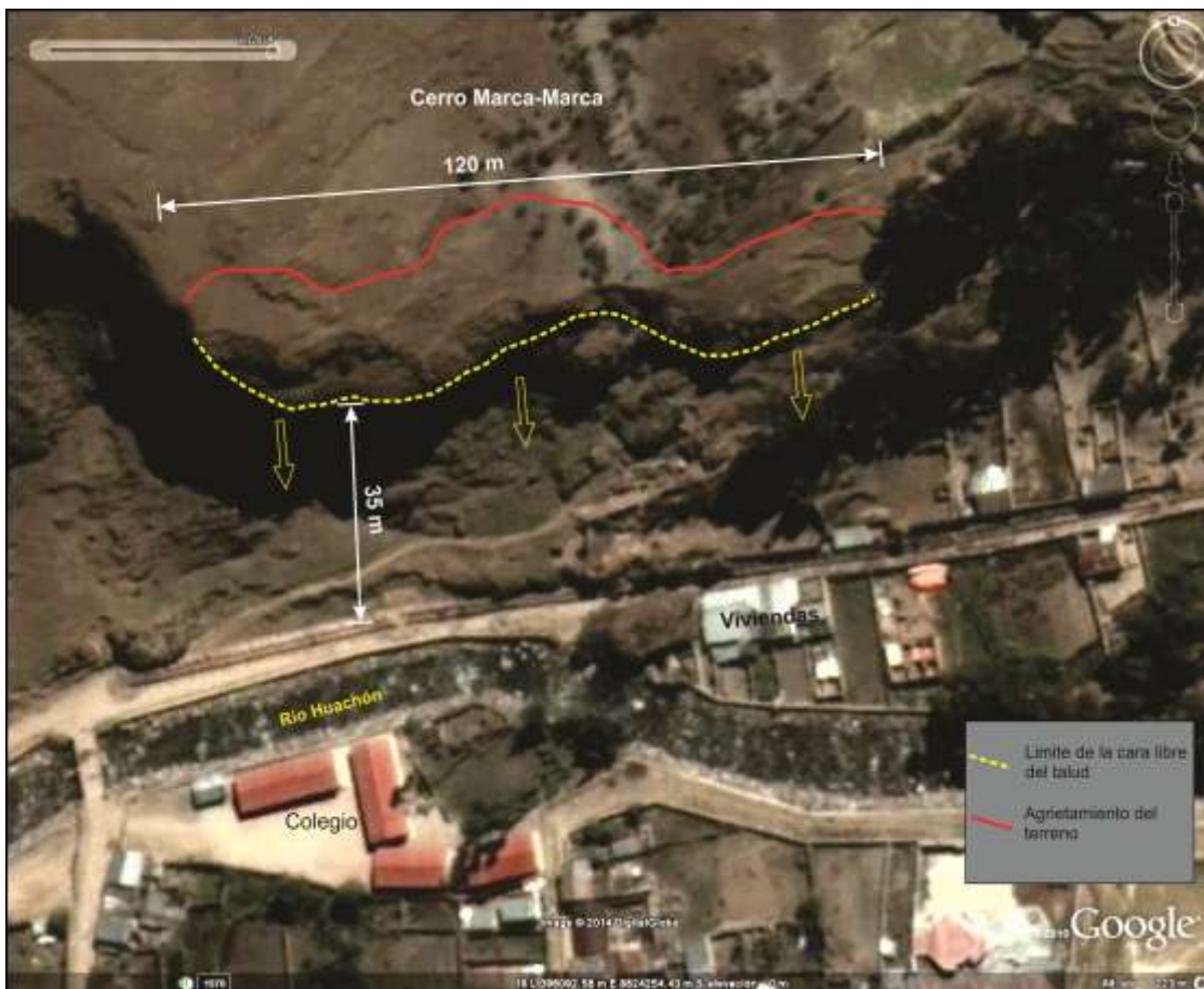
Figura 6. Se muestra el agrietamiento del terreno y la cara libre del talud.
