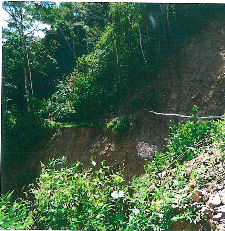
Foto 18. Pared de la quebrada, se muestra la inestabilidad del terreno.
