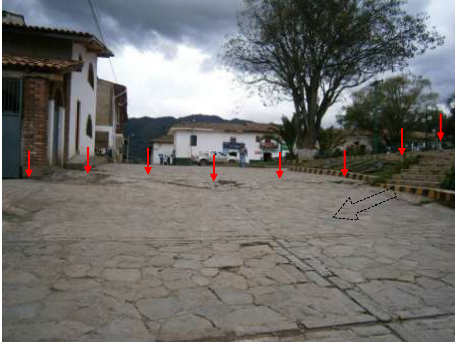
Foto 18: Las flechas rojas marcan el flanco derecho del deslizamiento C que afecta la mitad de San Luis, presenta un desnivel de 0.20 m y la dirección de movimiento del terreno es N140°.
