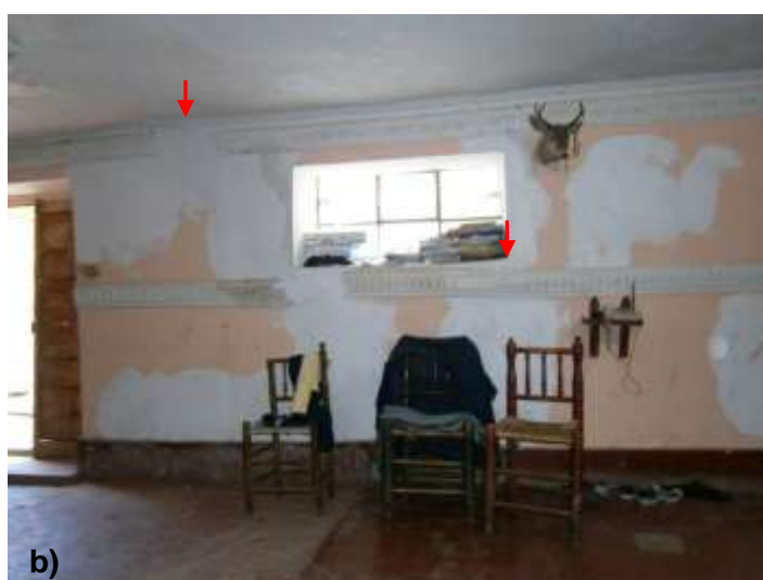
Foto 29: En a) se observa las grietas en el comedor y en b) se muestra en flechas rojas evidencias de hundimiento en la vivienda ubicada en la Av. Fitzcarrald.
