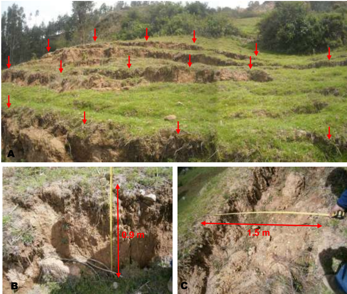
Foto 09: a) Escarpes simultáneos, debido al movimiento del terreno, b y c son las medidas de desnivel y abertura generadas debido al movimiento del terreno.
