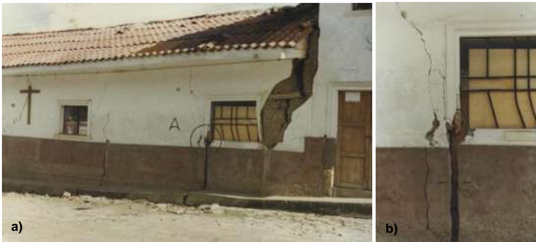
Foto 25: En a) se observa la Casa Parroquial dañada, en b) se observa a detalle los esfuerzos y la dirección del agrietamiento. Plaza de armas de San Luis. L. Fidel 1996
