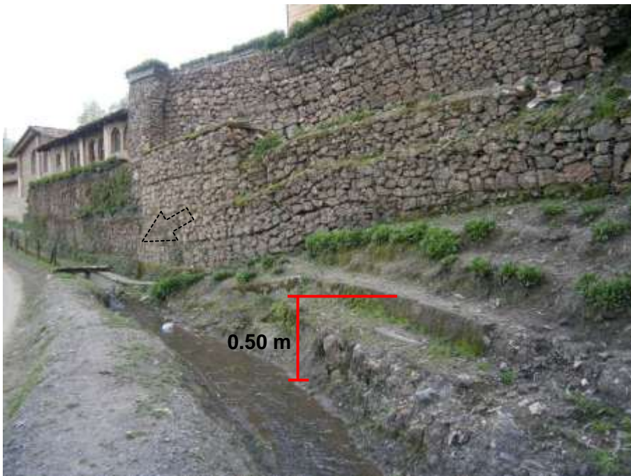
Foto 19: Muro de gaviones del vivero Chuyayacu afectados por el deslizamiento C.
