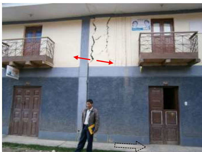
Foto 30: Vivienda afectada por el deslizamiento H-3, la abertura que presenta es de 0.08m. Vivienda ubicada en la Av. Tupac Amaru.
