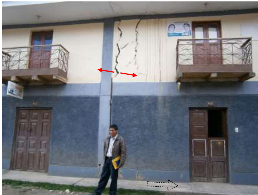
Foto 17: Vivienda afectada por el deslizamiento H-3, la abertura que presenta es de 0.08 m.
