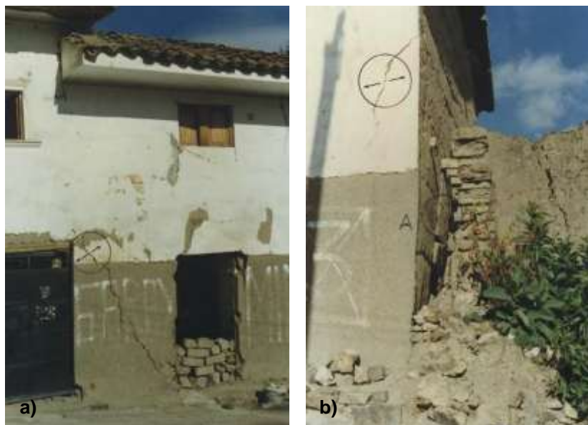
Foto 26: en la figura a) se observa vivienda agrietada y en b) además del agrietamiento presenta un combamiento en la pared. L. Fidel 1996.
