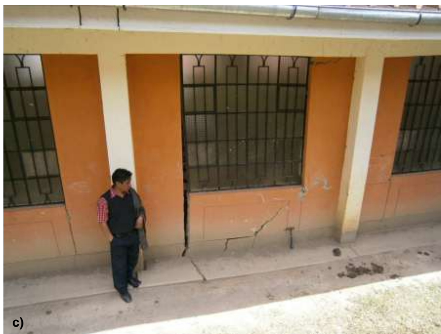
Foto 28: En a) se observa el teatrín del colegio agrietado, en b) columnas afectadas debido al empuje del terreno y en c) las aulas de inicial completamente deterioradas. Centro Educativo Badiali Marisoni.
