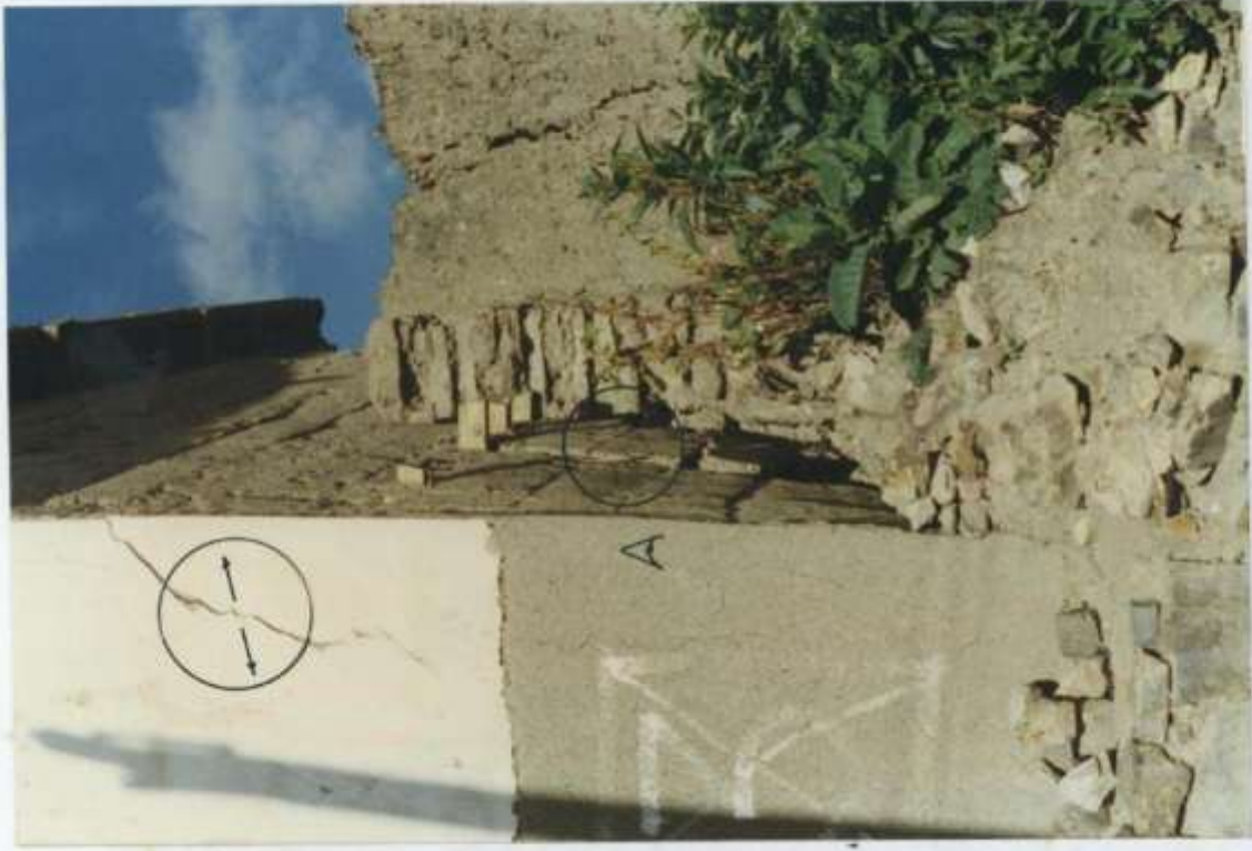
Foto 11: Detalle de la vivienda anterior. A: combamiento de la pared y agrietamientos.
