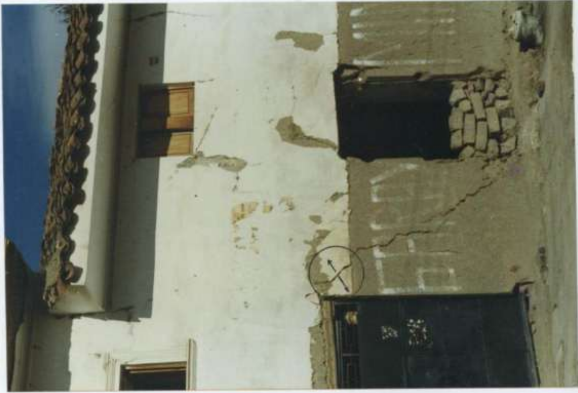
Foto 10: Fuertes agrietamientos en vivienda abandonada a la entrada a San Luis.
