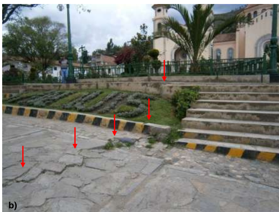
Foto 31: En a) y b) se observa el desnivel en la plaza de armas debido al movimiento del deslizamiento C, la grieta pasa toda la plaza de armas, afectando la casa parroquial y la Iglesia de San Luis.
