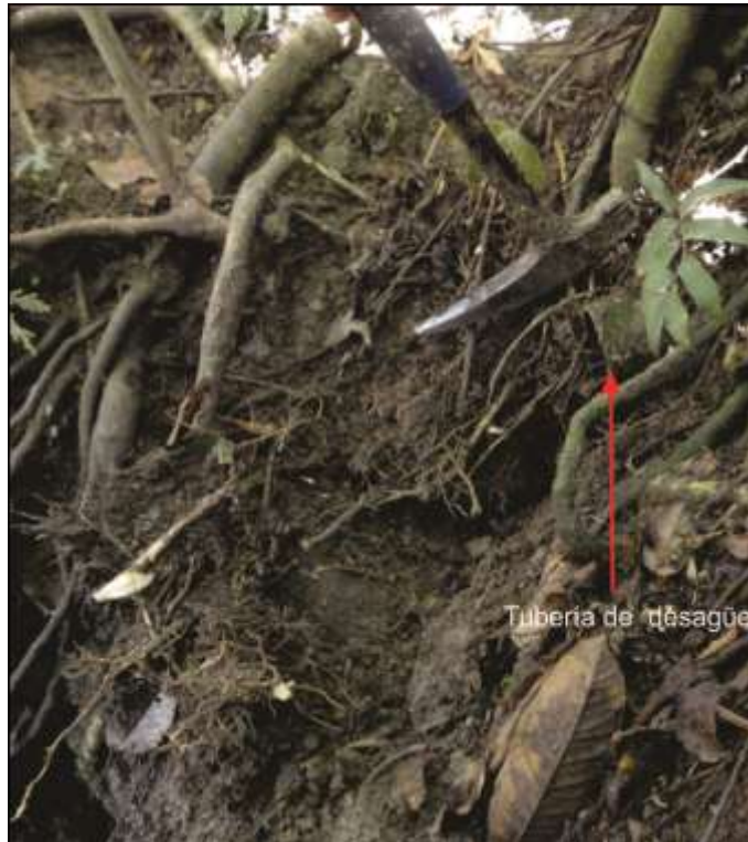
Foto 62. Tubería de desagüe que vierte aguas servidas al terreno.
