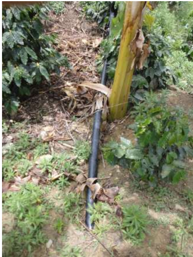
Foto 56. Tubería de agua potable San Miguel-Santo Domingo.
