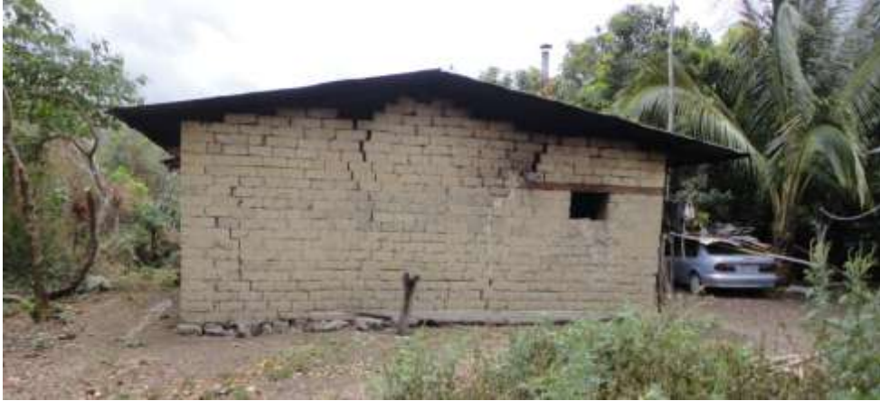
Foto 55. Vivienda afectada por el movimiento del deslizamiento.
