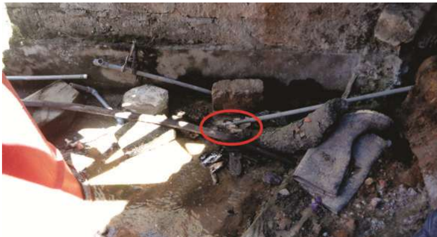
Foto 63. Tuberías de agua potable rotas, donde el agua se infiltra al subsuelo.
