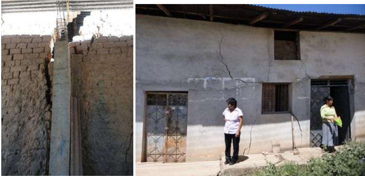
Fotos 71 y 72. Paredes agrietadas.
