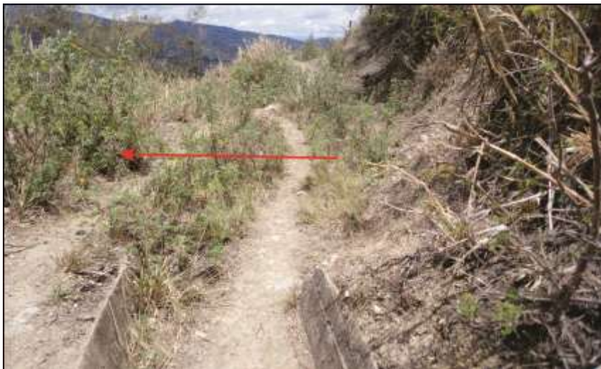
Foto 57. Canal de regadío abandonado por el colapso de su estructura.
