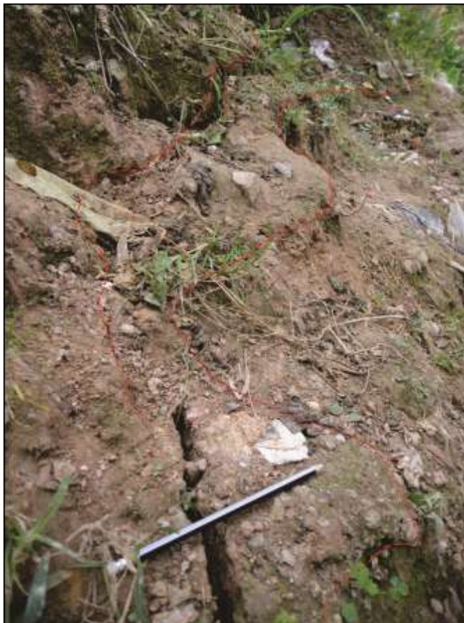
Foto 14. Agrietamientos del terreno.
