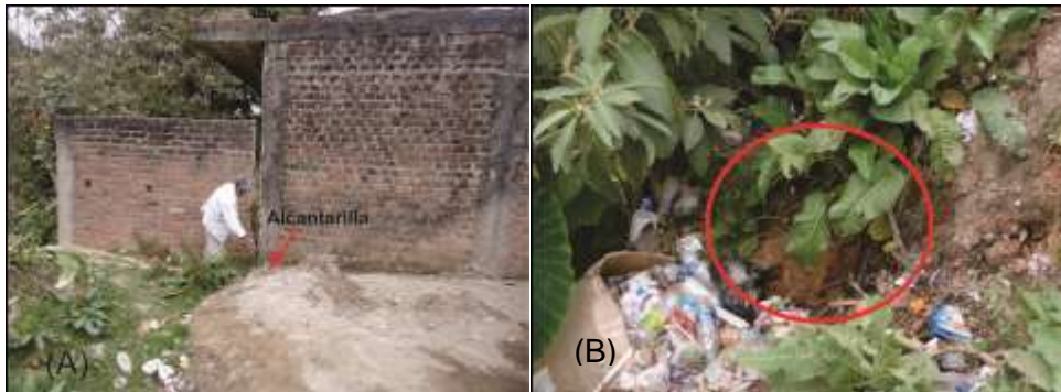
Foto 16. Filtraciones de agua, (A) Alcantarilla sin agua. (B) Filtraciones de agua proveniente de la alcantarilla.
