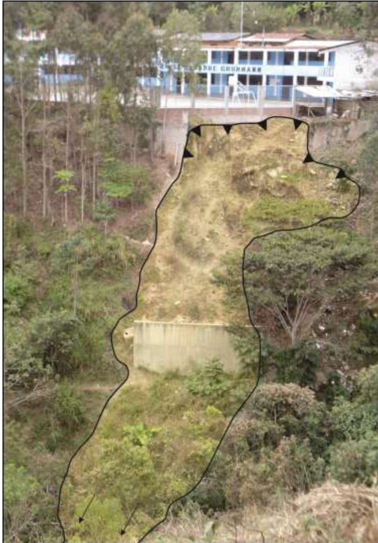
Foto 13. Se muestra del deslizamiento que afectó al cerco perimétrico del C.E.
