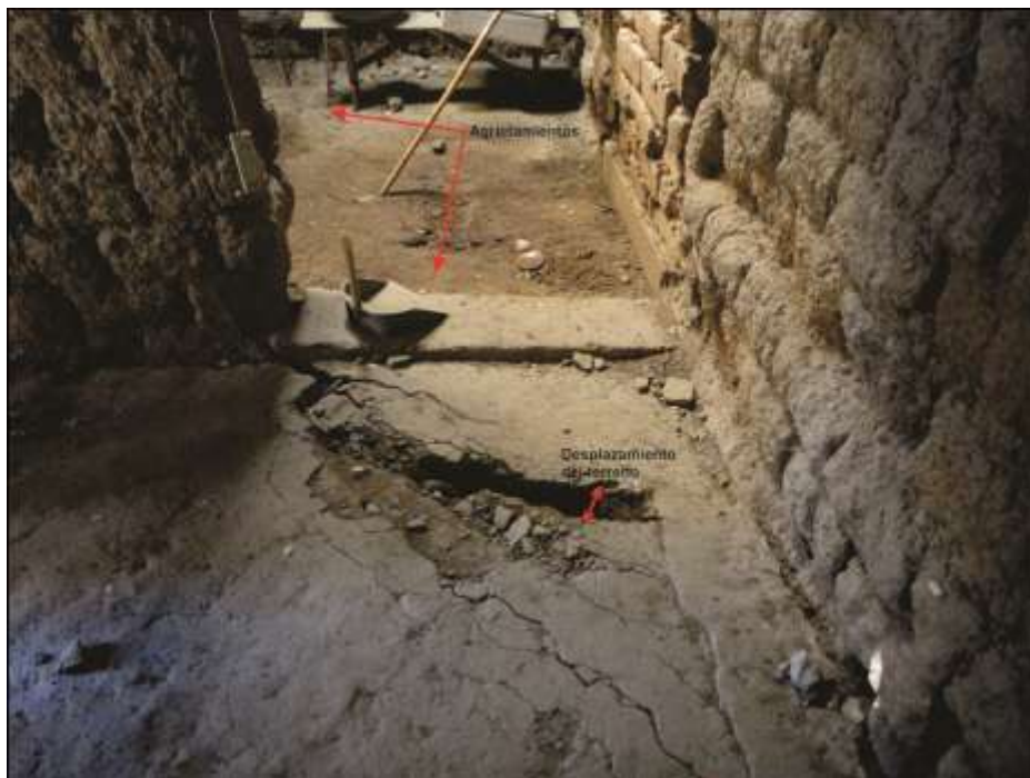
Foto 70. Se muestra el agrietamiento del terreno y su desplazamiento vertical y horizontal.
