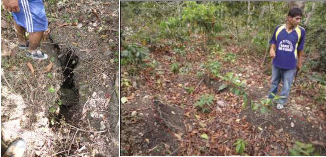
Foto 59. Agrietamiento del terreno, parte alta del centro poblado La Laguna.
