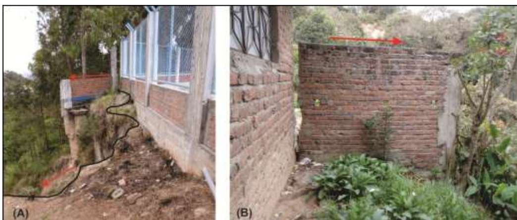
Fotos 15 A y 15 B. Se muestra la inestabilidad del terreno, los muros están ligeramente inclinados que pueden colapsar. (A) sector cerca al cerco perimétrico. (B) Parte del cerco colindante al aula del C.E.
