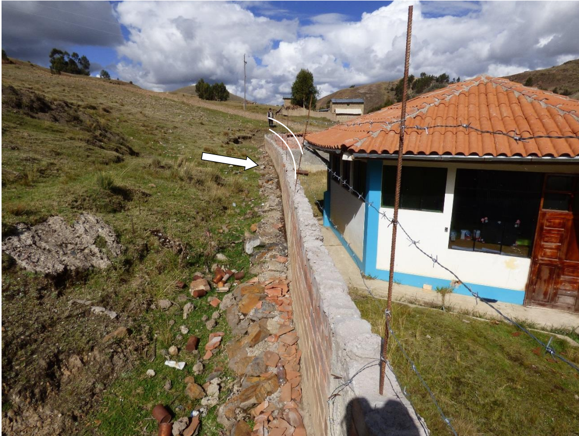
Figura 21. Se observa el cerco perimétrico de la Institución Educativa Inicial deformada.
