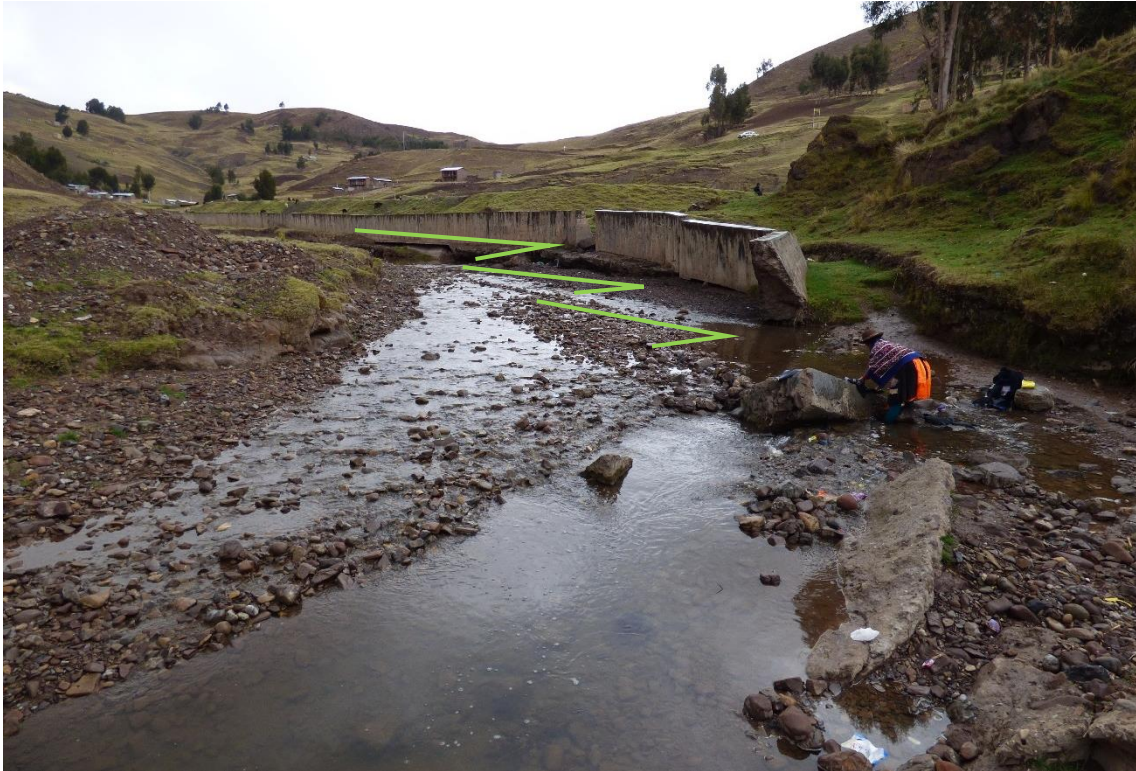
Figura 23. Muros de contención afectados por erosión fluvial (flechas verdes) al sur de Chucllaccasa.
