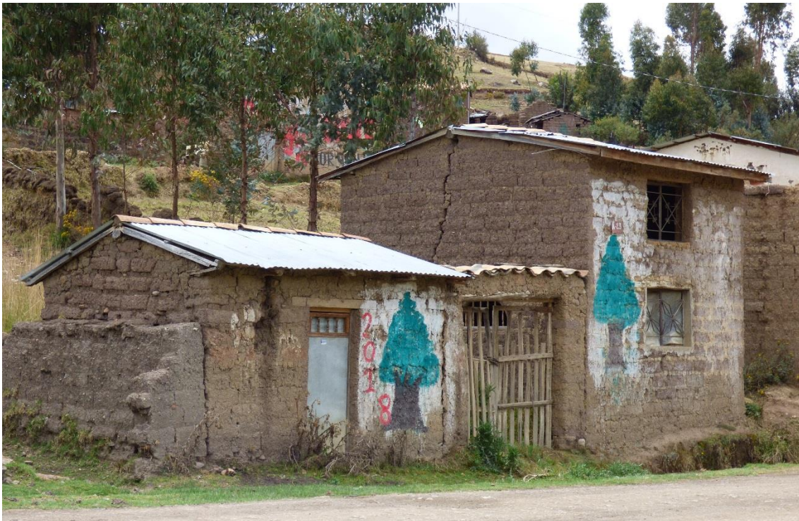
Figura 15. Se observa viviendas afectadas por asentamientos generados por deslizamientos del sector sureste de Chuclaccasa.
