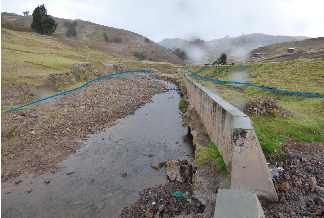
Figura 24. Muros de contención afectados, construidos en el cauce inundable del río (delimitados por las líneas azules).
