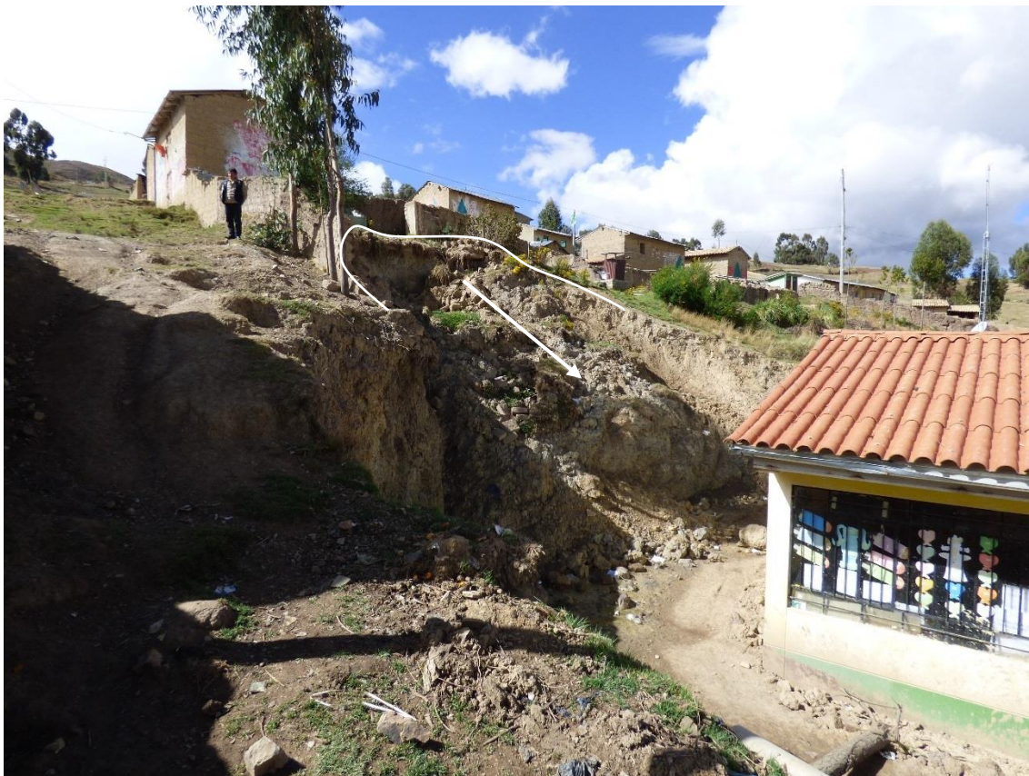
Figura 19. Deslizamiento que afectó infraestructura de la I.E.P. N°36304.
