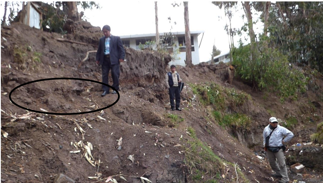
Figura 26. Grietas con emanaciones de gases (humo).
