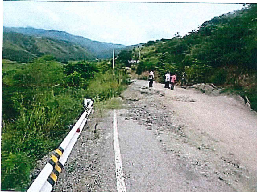
Figura 18. Imagen del tramo de carretera asfaltada Cunia – Chirinos, afectada por movimientos en masa, ocurridos en marzo del año 2018
