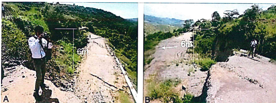
Figura 16. Deslizamiento en la parte alta del caserío Cunia, A) vista tomada con dirección sureste del escarpe principal B) vista tomada con dirección oeste de la misma.
