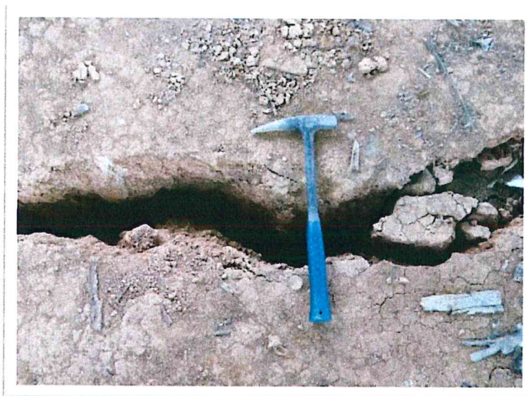
Foto N° 9: Grietas progresivas, de 10 cm a 15 cm de ancho en promedio, con rumbo S80°E, en la parte superior del centro poblado San Agustín, en dirección hacia el río Apurímac.
