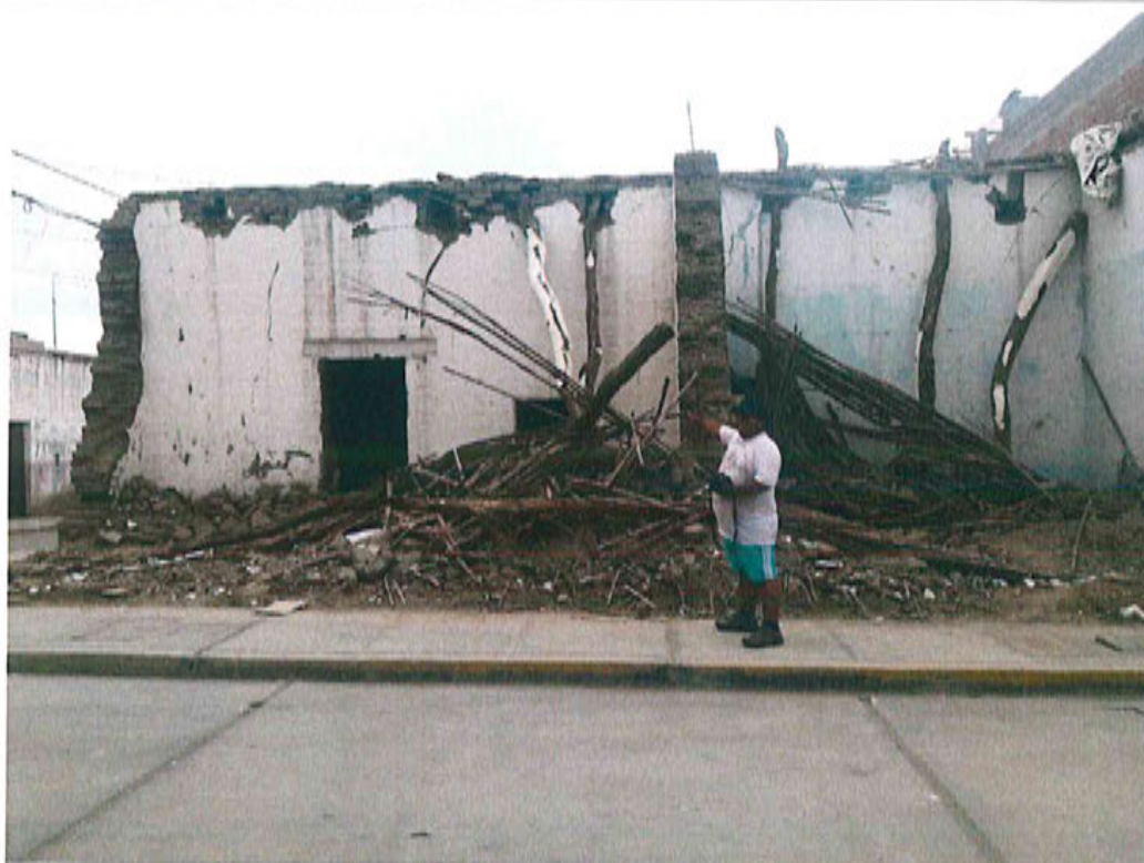
Se observa vivienda con muros de adobe en mal estado de conservación, en proceso de colapso como consecuencia de inundación, sismo u otra fuerza.
