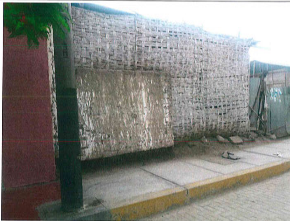
Vivienda con muros de quincha y techo con cobertura de calamina, se observa presencia de humedad en sus cimientos y daño severo en los muros de quincha.
