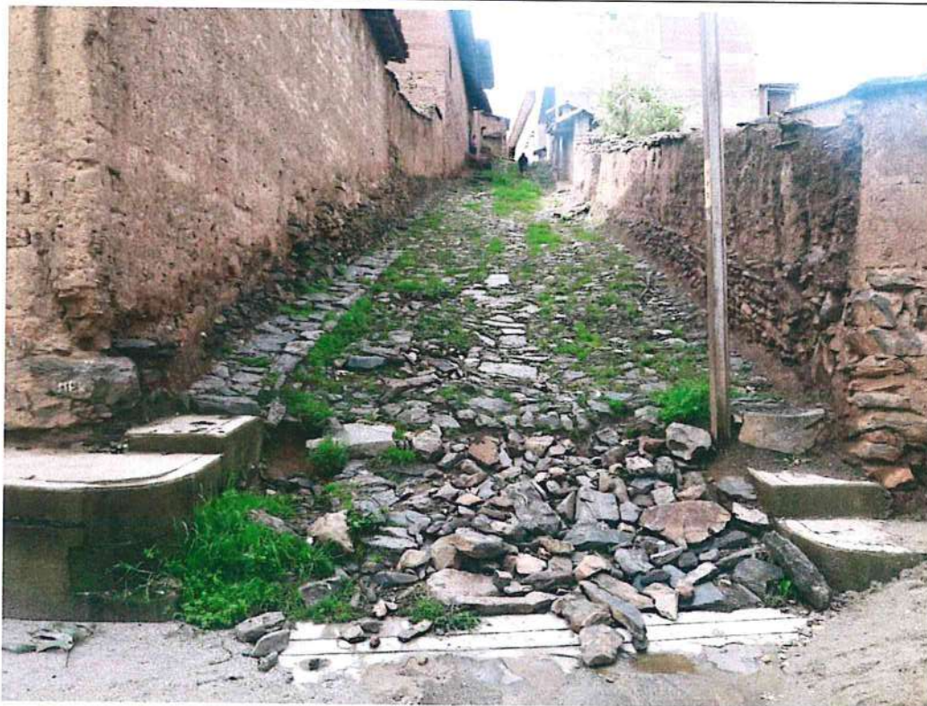
Se observa calle erosionada y colindantes viviendas con muros de adobe afectados por presencia de humedad, en proceso de colapso.
