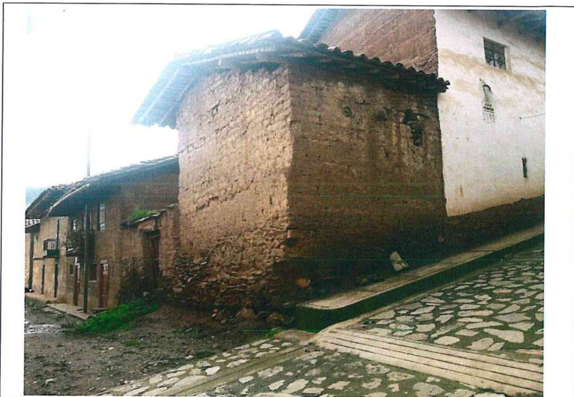
Se observa vivienda con la cimentación erosionada, que podría generar colapso de la misma
