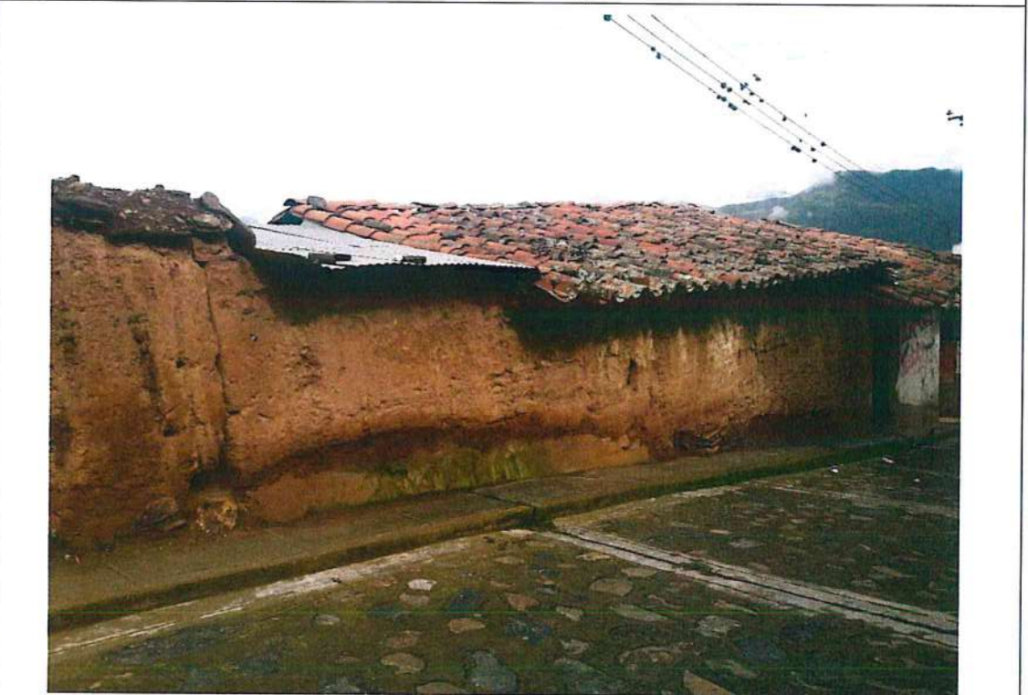
Se observa edificación con muros de adobe y techo con torta de barro con severo deterioro de sus estructuras.
