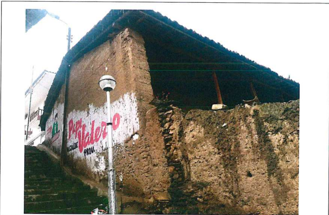
Vivienda con muros de adobe y cobertura de calamina, en donde verifica que parte de los muros de adobe, se encuentra agrietados en proceso de colapso.
