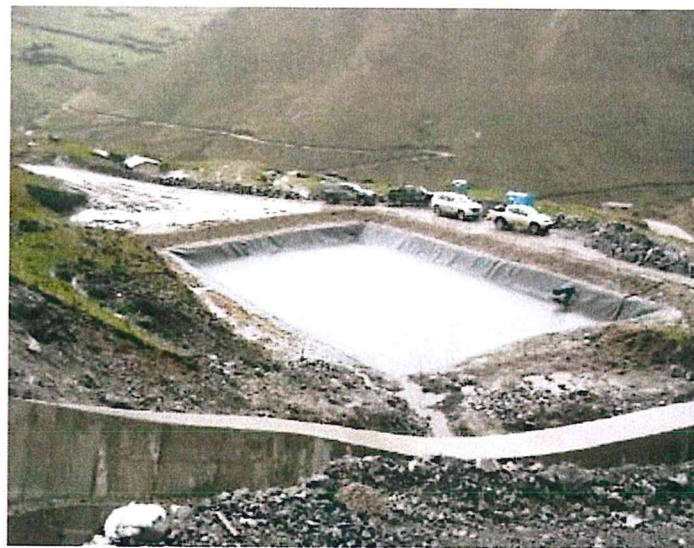
Foto N° 3: Poza de contención de filtraciones (LVU), de 25 m de largo por 15 m de ancho, aproximadamente, revestida con geomembrana de 3 mm de espesor.
