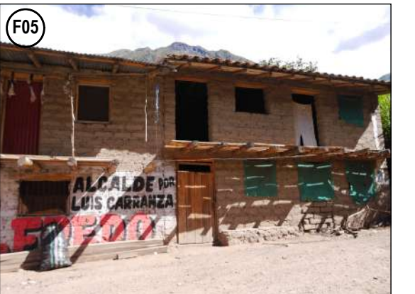
F05.- Elemento Expuesto - Viviendas con muros de adobe con pisos intermedios a desnivel sin junta sísmica. Techo de calamina a dos aguas. Puertas y ventanas de madera.
