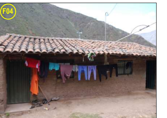
F04.- Elemento Expuesto - Vivienda con muros de adobe con techo de teja artesanal a dos aguas. Con puertas metálica y ventanas metálicas traslucidas.
