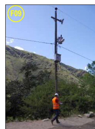
F09.- Elemento Expuesto Linea electrica de Distribución. Transformador electrico adyacente al centro educativo inicial
