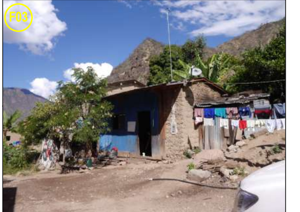
F03.- Elemento Expuesto - Vivienda mixta con muros de adobe y madera, con techo de calamina a dos aguas de un solo nivel. Con puertas y ventanas de madera.
