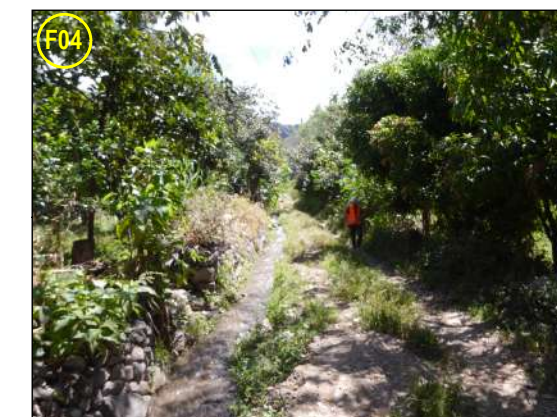
F04.- Elemento Expuesto - Trocha carrozable en dirección a los centros educativos. Se ubica un canal lateral de riego al margen derecho. Ancho de calzada 3.0m. Superficie de rodadura deteriorada
