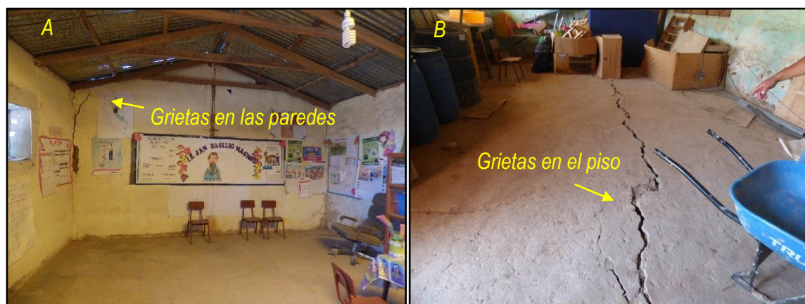
Foto 9. Vista de la Institución Educativa San Basilio Magno 408. a) Se observa grietas en las paredes de 5 cm de abertura. b) Grietas en el piso, con abertura de 10 cm.
