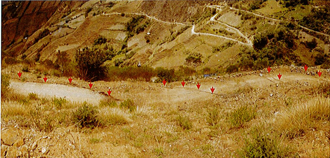
Foto 13: Se observan en flechas rojas los agrietamientos en el segundo desarrollo de la trocha carrozable Tomaykichwa – Chinchubamba.
