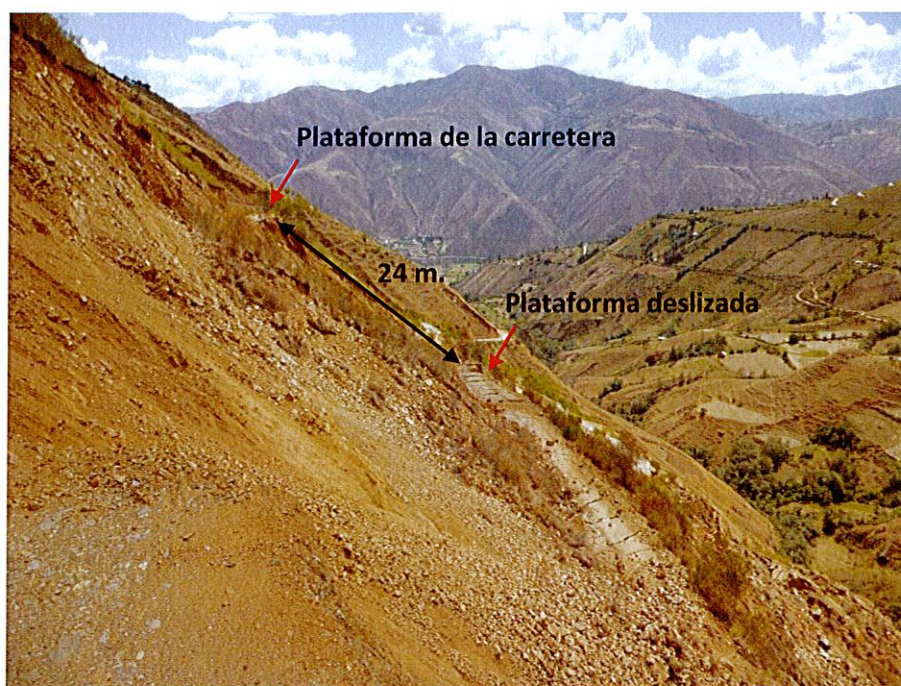
Foto 08: Se observa la destrucción de 90 m de la carretera, también se puede ver el desplazamiento de 24 m, siendo ya parte de la masa deslizada.
