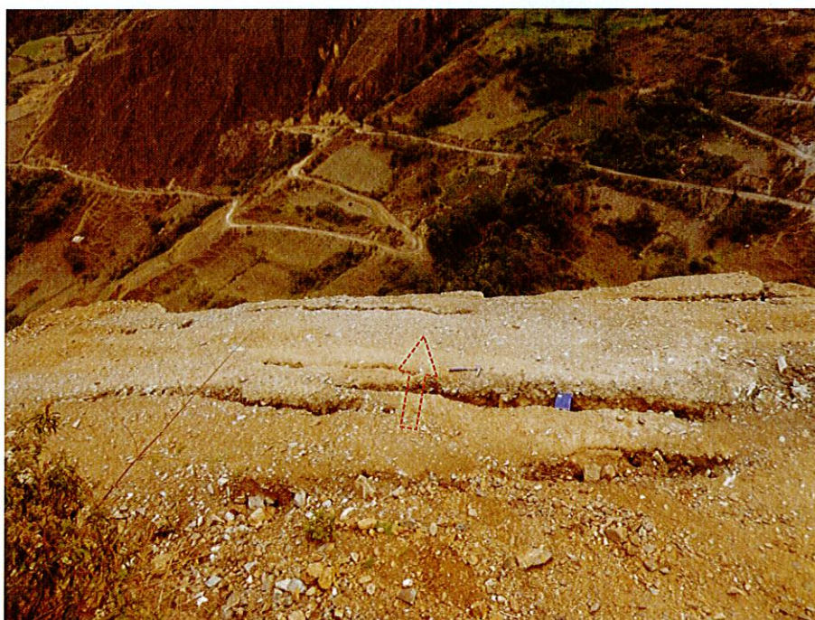
Foto 10: Se observan las grietas en la carretera con aperturas hasta 0.4 m y la flecha roja muestra la dirección del movimiento del terreno.
