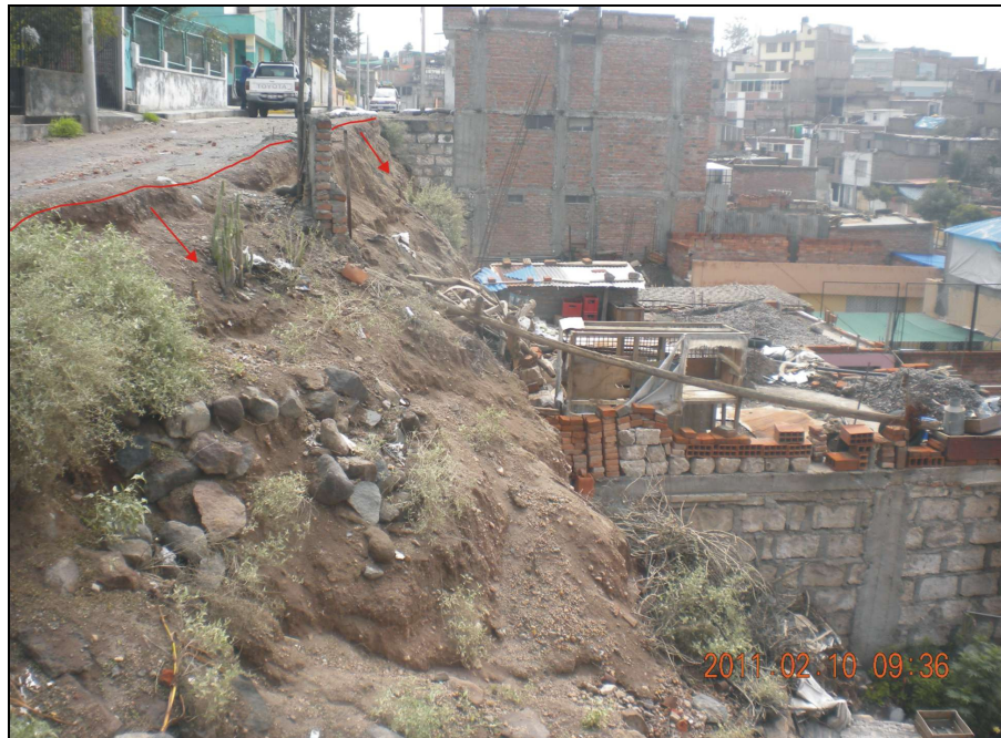
Foto N°14. Vista de la calle Mollendo (tramo 2) afectada por problemas de erosión de ladera y derrumbes
