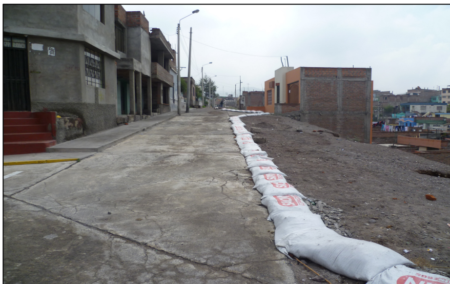
Foto N°11. Vista de la calle Mollendo (tramo 1), la cual en parte está cubierta con losas de cemento. El derrumbe se produce en el extremo derecho (zona descubierta).
