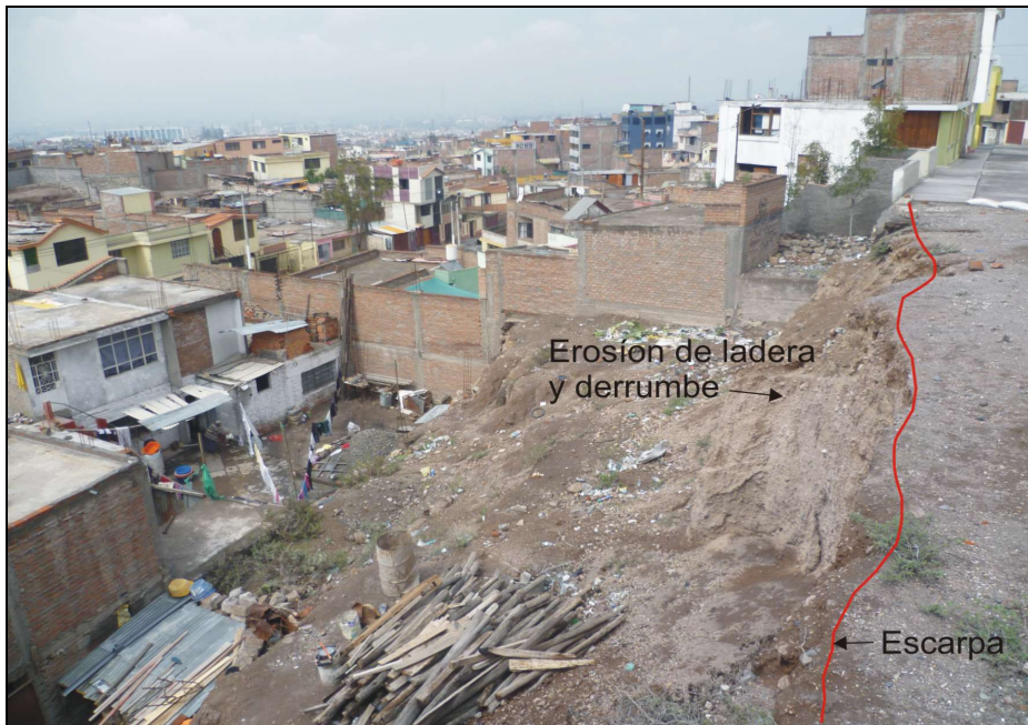
Foto N° 12. Vista del talud inferior de la calle Mollendo (tramo 1) donde se aprecia la escarpa de la zona de derrumbe.
