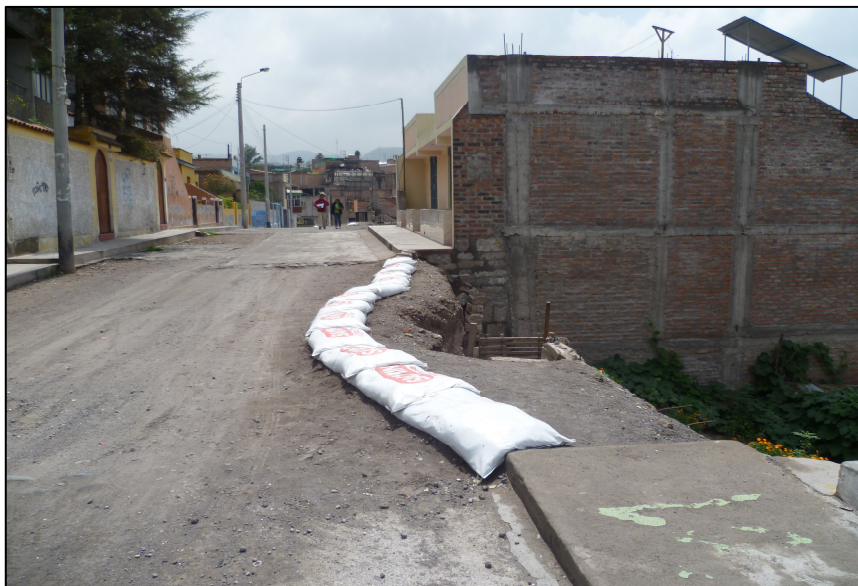
Foto N°15. La calle Mollendo (Tramo 3) en su borde oriental es afectada por procesos de erosión de laderas y derrumbes.
