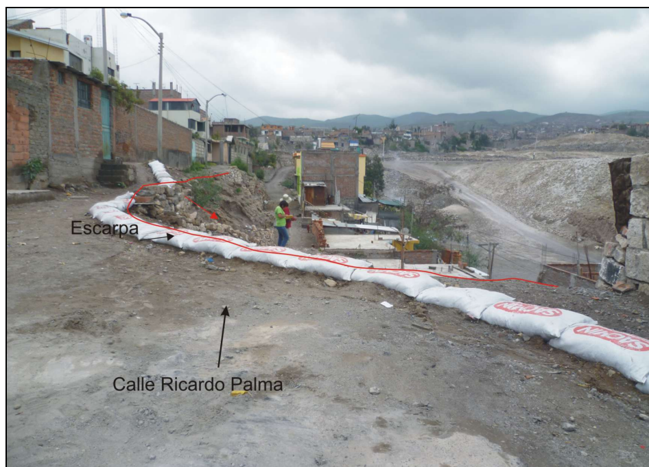
Foto N° 8. Vista de la calle Ricardo Palma (tramo 2) donde se aprecia que parte de dicha calle, postes de luz y tubos de agua y desagües vienen siendo afectados por problemas de erosión y derrumbes.
