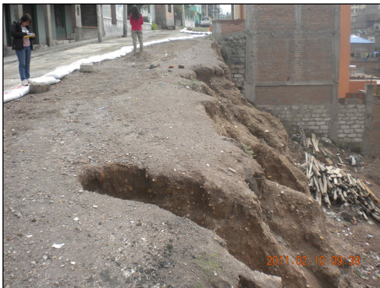
Foto N o 1. Los suelos en el Distrito de Alto Selva Alegre son muy poco desarrollados. Aquí una vista de un depósito de flujo piroclástico en la calle Mollendo donde el suelo es casi inexistente.
