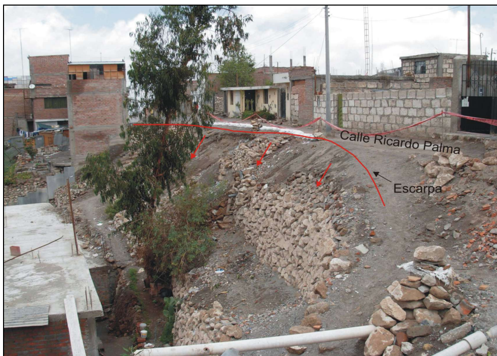
Foto N°6. Cuarta cuadra de la calle Ricardo Palma donde los procesos de erosión y derrumbe vienen afectando dicha calle. Es necesario resaltar que anteriormente los pobladores han realizado pircas para estabilizar el talud.
