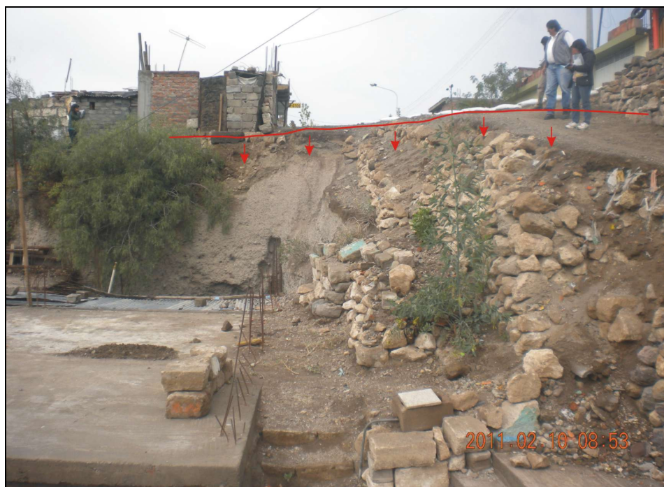
Foto N° 7. Vista de la Calle Ricardo Palma (tramo 2) que viene siendo afectado por problemas de erosión y derrumbes.
