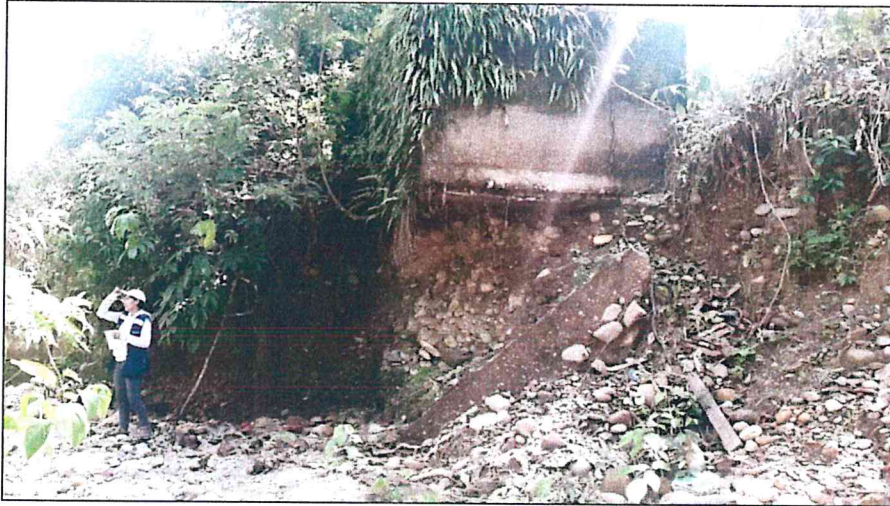
Fotografía 8. Vista de la margen derecha de la quebrada Chaupimayo (zona baja) viene siendo socavada por la dinámica fluvial de la quebrada.
