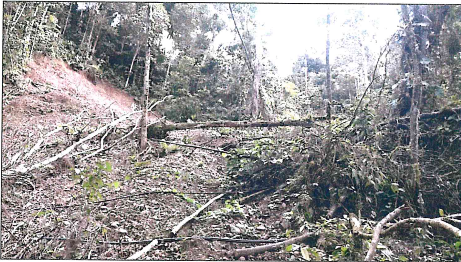
Fotografía 11. Vista de un deslizamiento rotacional a la margen derecha de la quebrada Chaupimayo.
