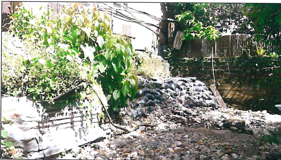
Fotografía 7. Vista de muro con bolsacretos que protege la margen izquierda de la quebrada.
