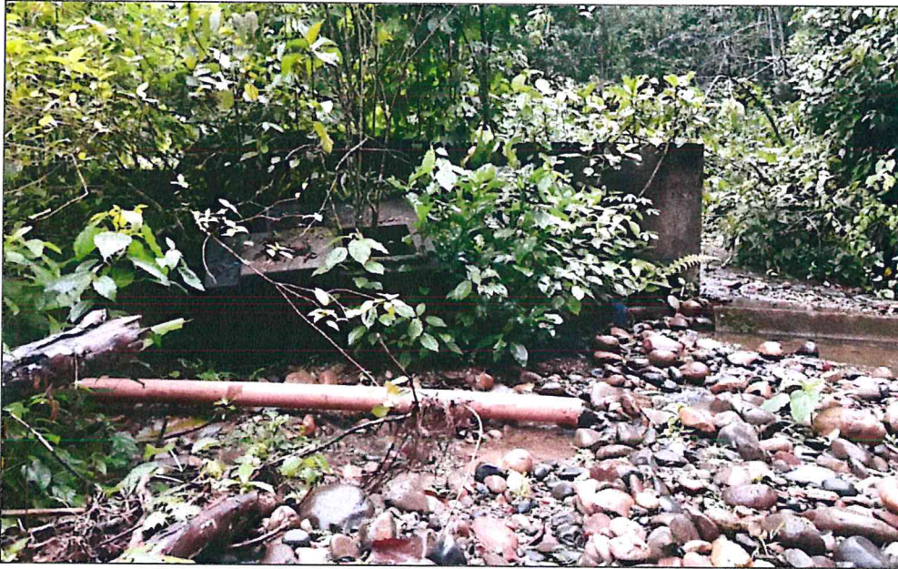
Fotografía 16. Vista de la captación de agua potable, el cual colapso producto de la avenida del flujo de detritos
