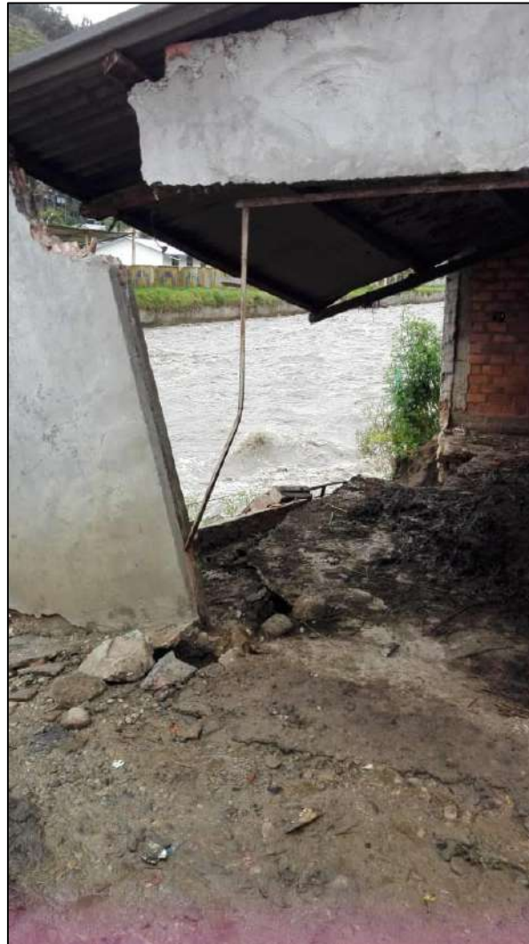
Figura 07: Viviendas construidas al margen del río se encuentran dañadas
