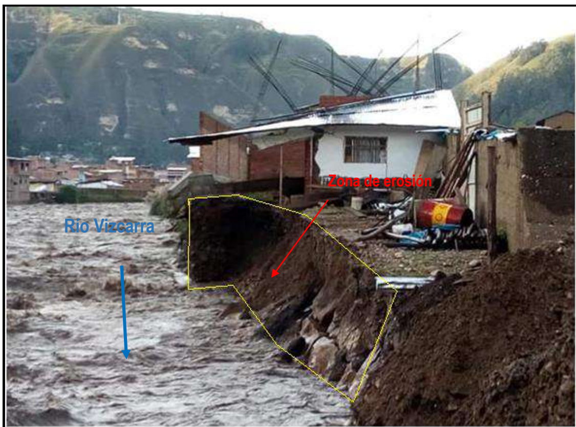
Figura 29: Acción erosiva del río Vizcarra que afecta áreas de acceso y las casas de dicha localidad
