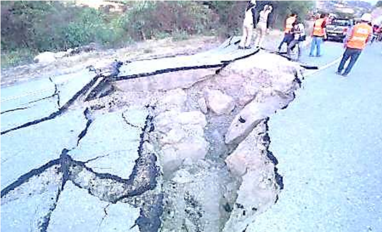
Foto 1: Carretera agrietada en el km 1161+370
