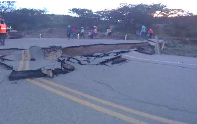
Foto 2. Agrietamiento y desplazamiento vertical en la
