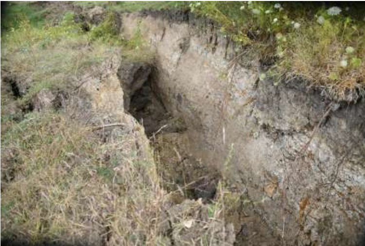
Foto 5: Desplazamiento del terreno, aperturas hasta de 3 m, con profundidades visibles hasta de hasta 4 m.
