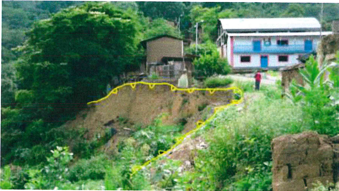
Figura 6. Deslizamiento rotacional en la zona urbana del caserío La Esperanza (Sosa & Lara 2019).
