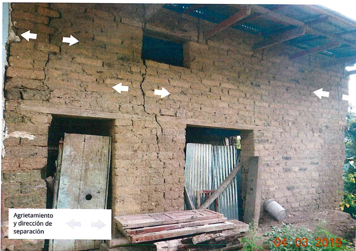
Figura 7. Agrietamientos en una vivienda ubicada en el flanco izquierdo de corona del deslizamiento que afecta zona urbana del caserío La Esperanza.
