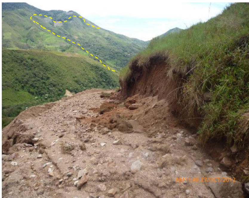
Foto 8. Derrumbe en la margen derecha de la quebrada, afectó varios tramos de la carretera al caserío de Villano. (Foto M. D. Masma).
