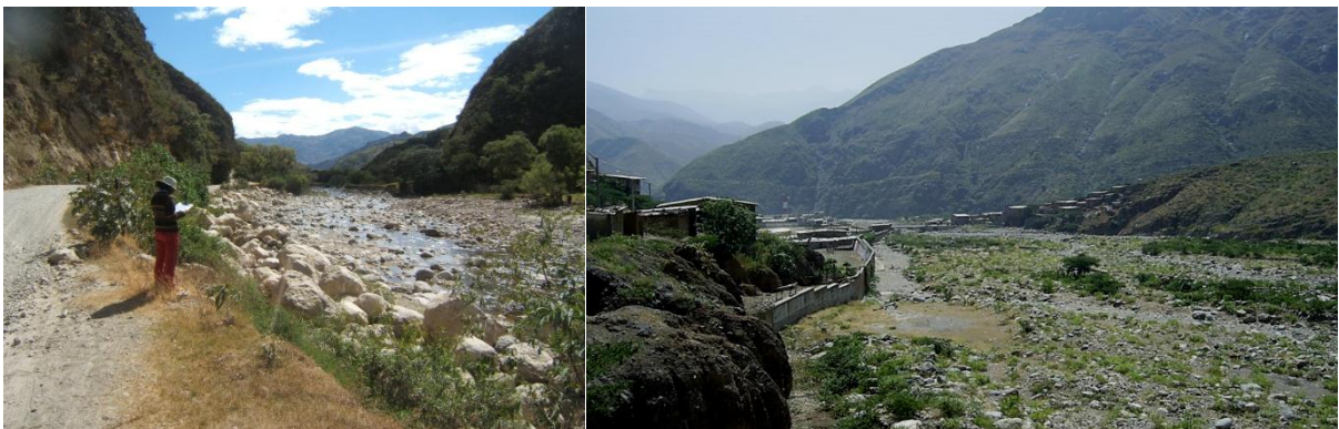
Foto 11. Ejemplo de uso de enrocados para protección de la plataforma de carretera (izquierda). En muchos casos esto debe estar acompañado de un levantamiento de la rasante de la carretera. A la derecha, protección de ribera con muros contra la erosión fluvial e inundación.
