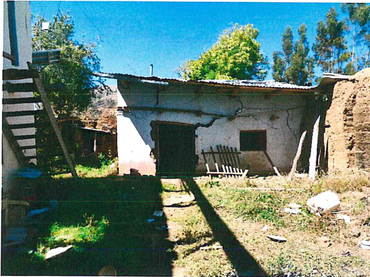
Fotografía 10. Viviendas afectadas por el asentamiento del terreno.
