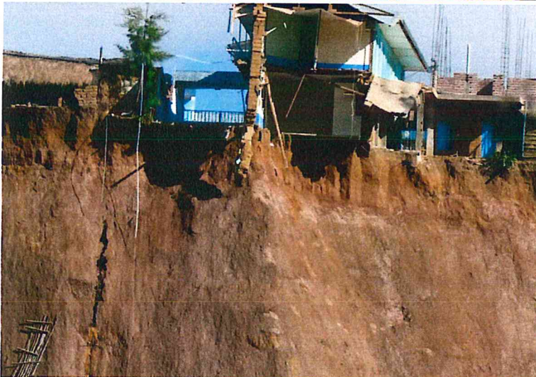
Fotografía 6. Vista frontal donde se aprecia el escarpe principal con desplazamiento recto. Además, viviendas semidestruidas.
