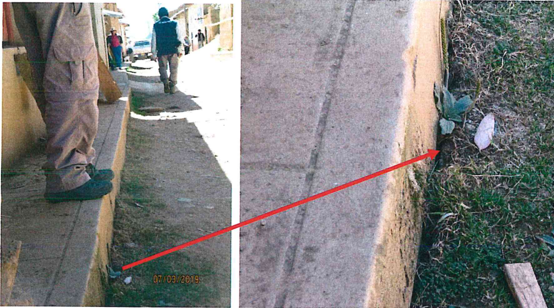
Figura 4. Separación entre el suelo y la vereda, índice del desplazamiento del terreno.
