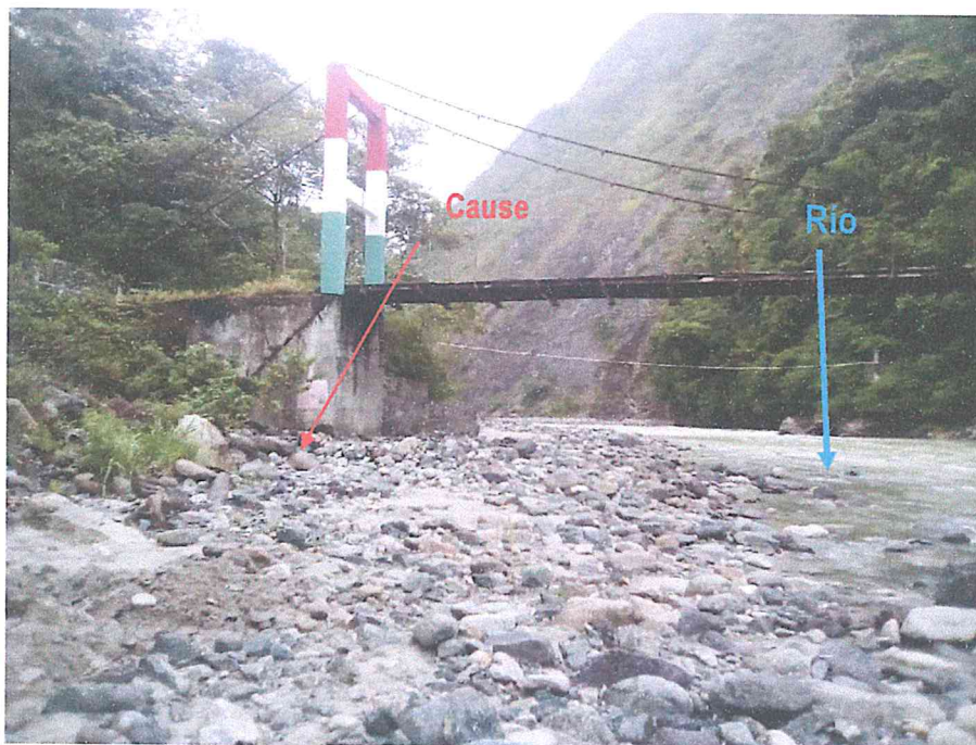
Figura 18: Acción erosiva del río Santa Cruz que afecta áreas de acceso y las casas de dicha localidad
