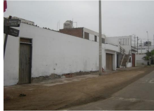
Figura 15. Vivienda de un nivel, afectada por problemas de salinidad en el sector 03.
