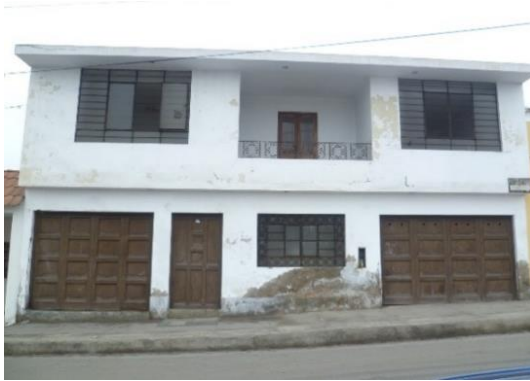
Figura 14. Edificación de 2 niveles, que presenta problemas por humedad en el sector 03.
