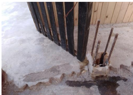
Vista de edificaciones acero en proceso de oxidación
