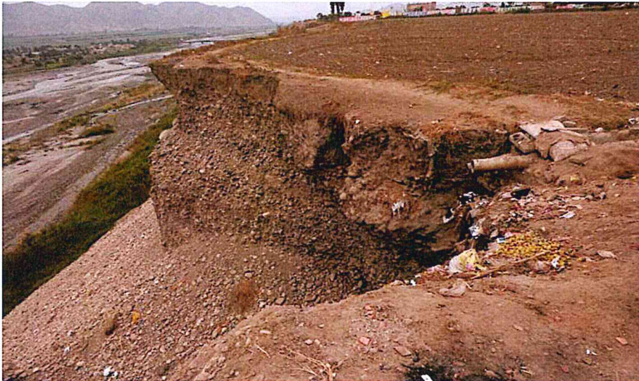
Foto 25. Desagüe proveniente de los terrenos de cultivo, vertido al talud.
