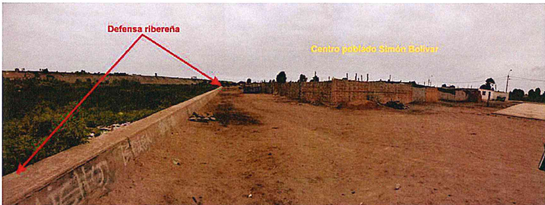
Foto 18. Muro de concreto, como defensa ribereña, en la margen derecha del río Pativilca.
