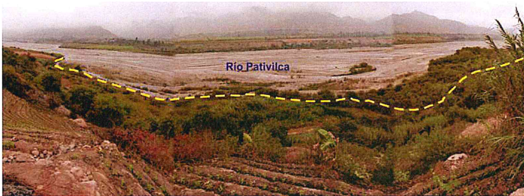
Foto 6. Sector de Espachin Bajo. La línea amarilla muestra el límite hasta donde llegó la erosión con lluvia excepcional.
