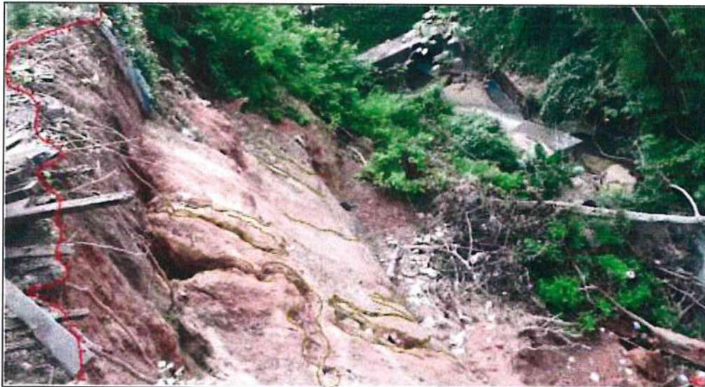
Foto 7: Árboles inclinados y caídos sobre la parte media de la ladera.
