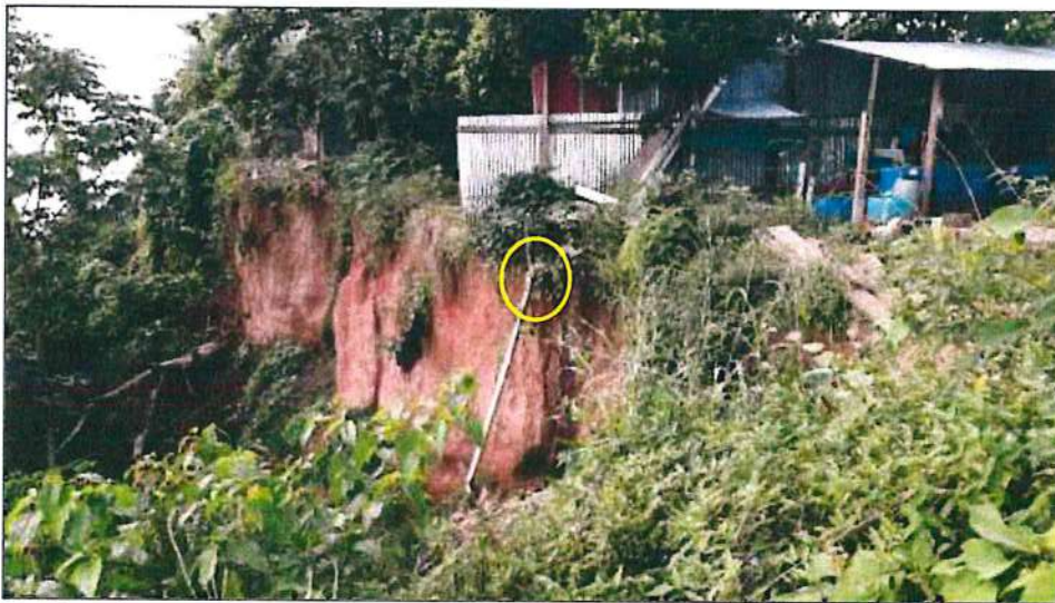
Foto 2: Vista de pequeños surcos formados por la escorrentía superficial y la filtración de agua de las tuberías que se encuentran en pésimas condiciones.
