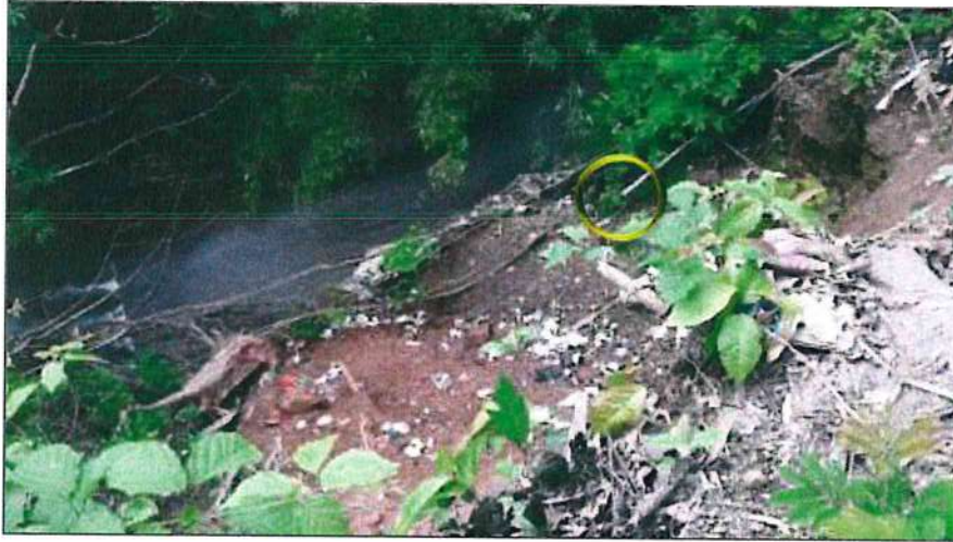
Foto 10: Vista del vertimiento de las tuberías de agua y desagüe sobre el pie de ladera
