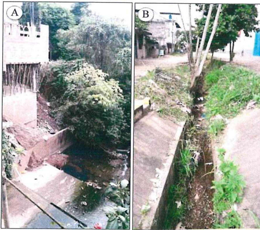
Foto 22: A) Cabecera del canal colector, en su base se almacena bastantes sedimentos (margen derecha de la cárcava). B) El sistema de alcantarillado a la altura del colegio 2 De Mayo, se encuentra obstruido por sedimentos, pastizales y basura.
