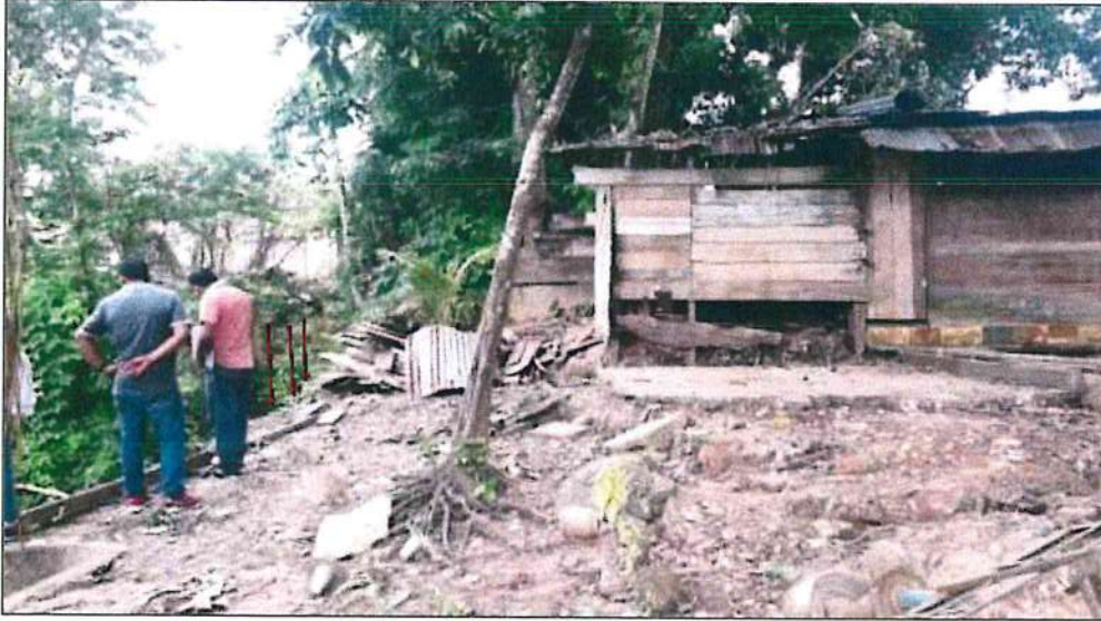
Foto 6: Vista de viviendas ubicadas a un metro del escarpe (las flechas rojas muestran el límite del escarpe).
