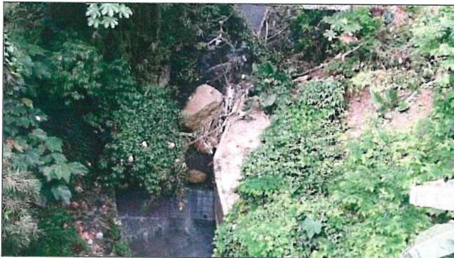
Foto 11: Caída de rocas en la base del canal colector.
