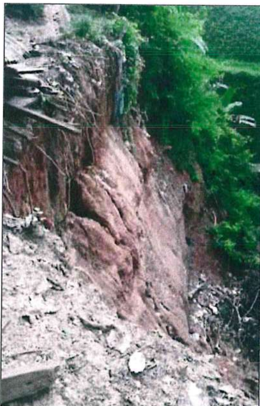
Foto 8: Evidencia de surcos producto de la escorrentía fluvial.
