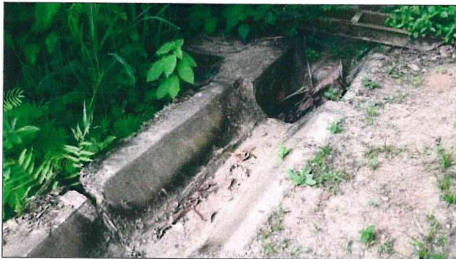
Foto 13: Vista del canal de drenaje en mal estado
