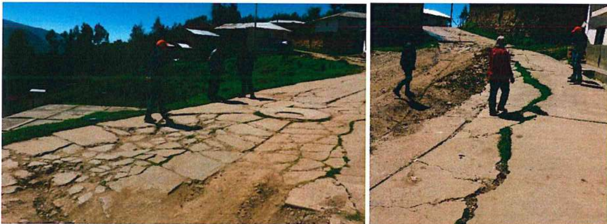
Fotografías 18 y 19: Pistas del Jirón Tupac Amaru fracturadas y agrietadas, producto del cambio constante de humedad en el terreno.
