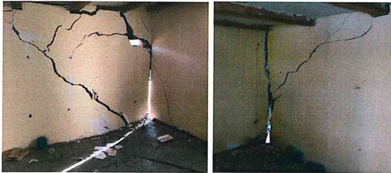
Fotografías 16 y 17: Pared interna de la misma vivienda que evidencia grietas diagonales en forma de V invertida generadas por asentamiento del terreno los cuales suelen presentarse en suelos arcillosos deteriorados por la circulación de agua.
