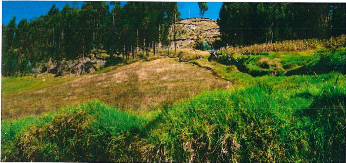
Figura 22: Secuencia de escarpes de deslizamiento activo en ladera Rucuchijirca cercano a canal de drenaje.
