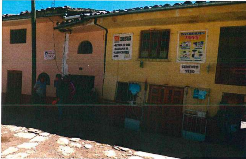
Fotografía 10. Pared externa de dos viviendas habitadas y situadas en el Jirón Tupac Amaru, las cuales muestran agrietamiento vertical de entre 3 a 5 cm de ancho. Se observa una apertura más ancha en la parte superior de la estructura; este caso suele presentarse cuando el suelo aumenta su volumen debido a la humedad, disminuyendo su resistencia y ocasionando que supere las cargas que los muros portantes transmiten al mismo empujando la estructura hacia arriba.
