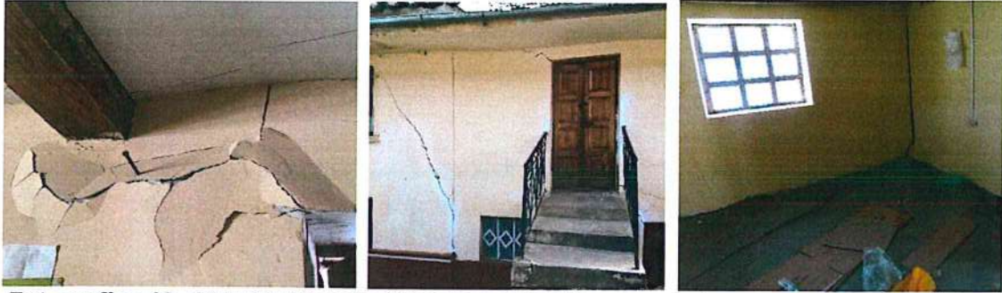
Fotografías 13, 14 y 15: Piso de vivienda fracturado y levantado con aperturas 6 a 7 cm de ancho.: Agrietamiento de 1 a 3 cm de apertura en pared externa e interna de una vivienda desalojada recientemente en el Jirón Tupac.
