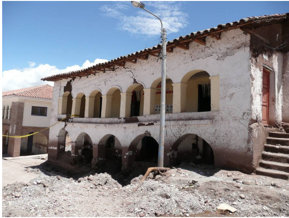
Foto 19: Una de los edificios más dañados fue este que se ubica en la Plaza de Armas de Zurite, este fue afectado por la fuerza del flujo en las columnas de adobe del edificio.
