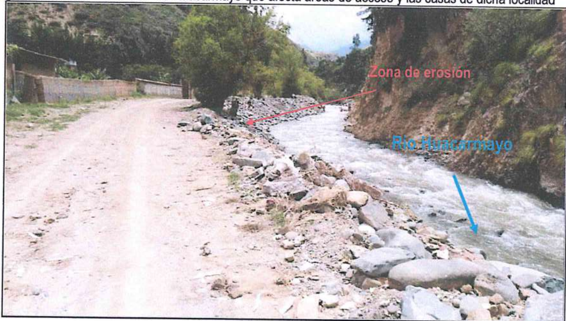
Figura 27: Acción erosiva del río Huacarmayo que afecta áreas de acceso y las casas de dicha localidad
