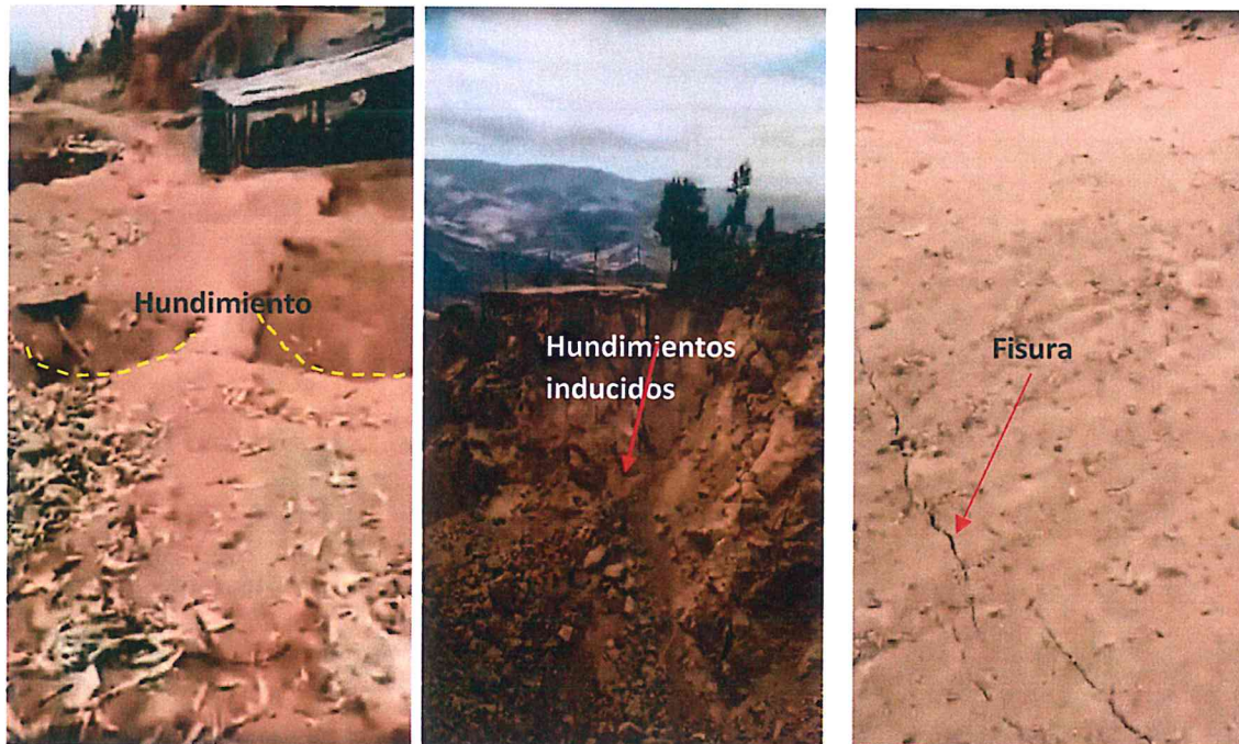
Figura 13. Evidencias de hundimientos y fisuras registradas en la entrada a la localidad de Salpo generados por la actividad minera informal. Fuente Periódística virtual: La Industria.
