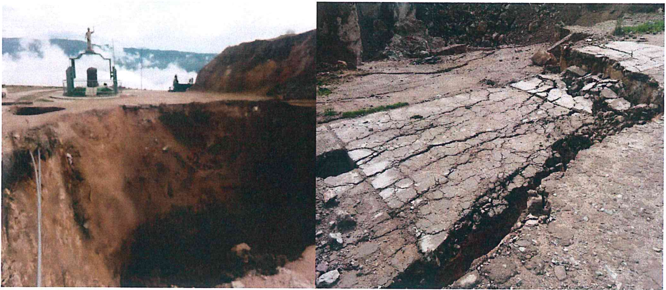
Figura 11 y 12. Vista del hundimiento de la carretera de losa de concreto a la entrada de la localidad de Salpo ocurrido el 22 de enero del 2019. Fuente: INDECI-SALPO, 2019
