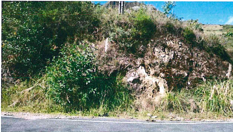
Foto 03. Se observa al lado de la carretera en las inmediaciones del caserío Huacás
