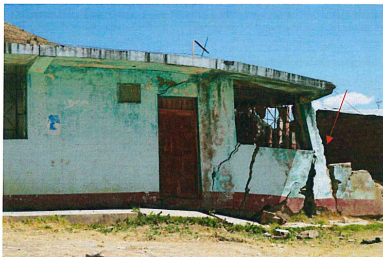
Foto 8: Vivienda con columnas comprometidas seriamente por las deformaciones en el terreno. Vivienda no habitable.
