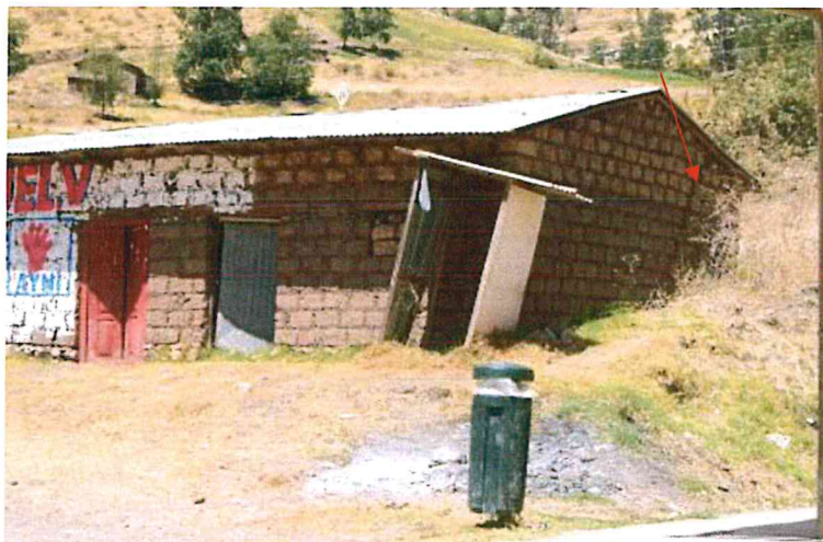
Foto 9: Vivienda con paredes inclinadas y agrietadas. No habitable.
