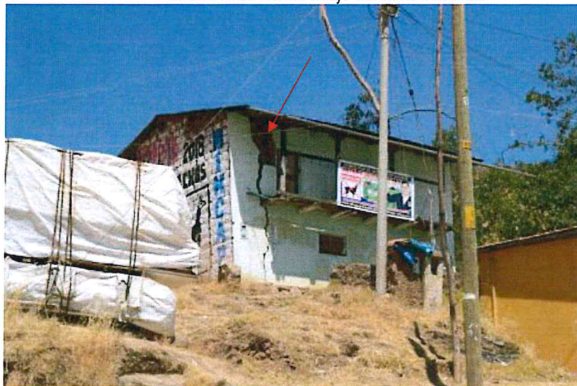
Foto 7: Vivienda con grietas en las paredes, no habitable.
