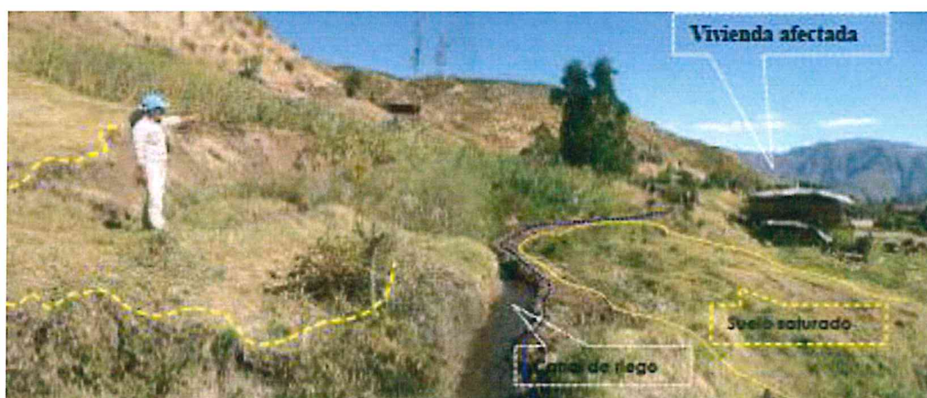
Foto 2: Canal de riego sin revestir, parte inferior del deslizamiento de Ccochapata. Fuente: Gómez H. & Medina L. (2009).
