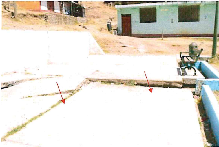
Foto 6: Losa de la plaza de armas de Pichuta, con deformaciones horizontales y verticales producto del movimiento ladera abajo del deslizamiento.
