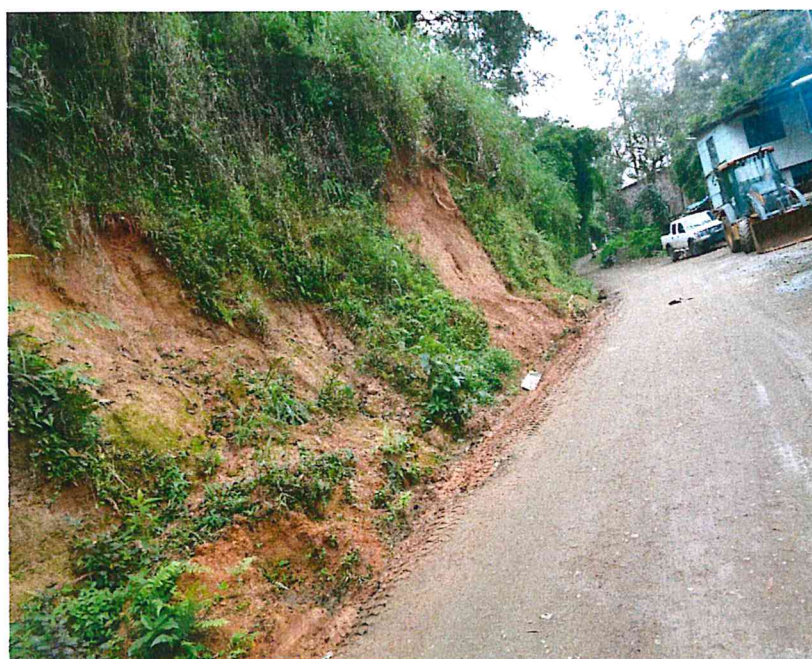
Foto 08: Roca intrusiva fuertemente alterada y meteorizada formando regolitos arcillosos que favorece a los movimientos en masa.
