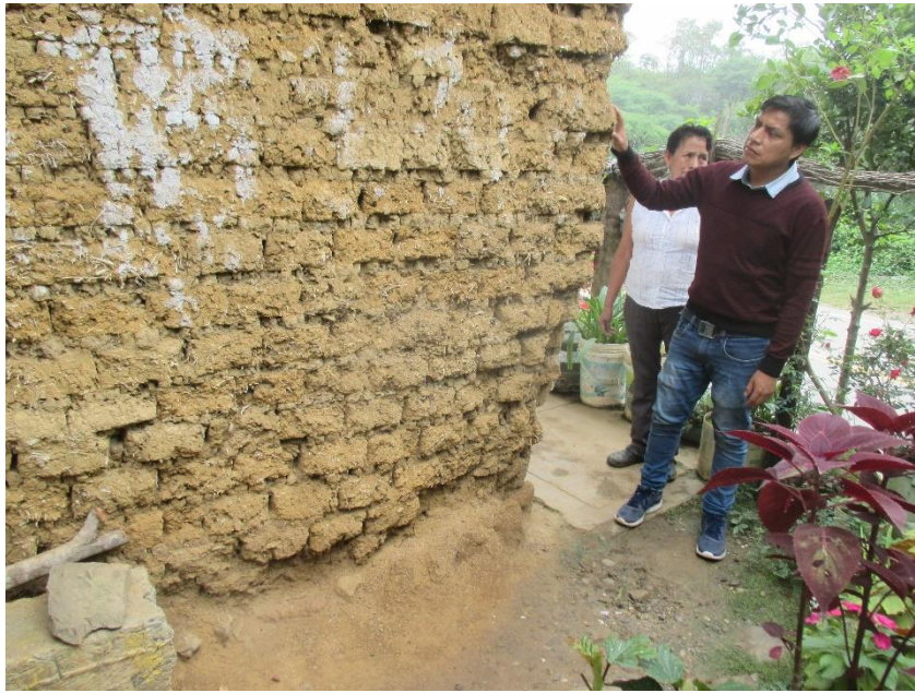
Foto 11: Se observa el desgaste de la parte inferior de la pared de la vivienda producto de salpicadura de lluvias y la inundación pluvial.
